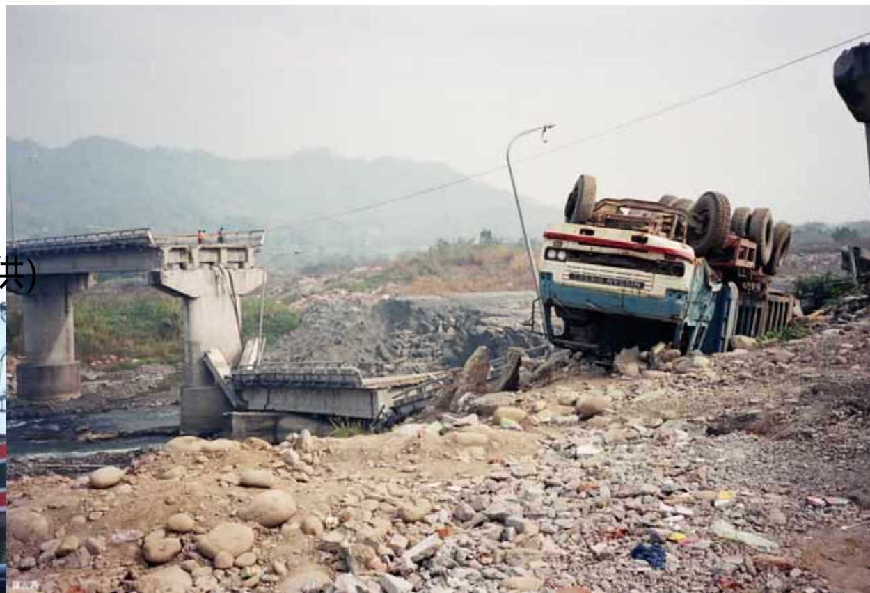
□ 斷層切過台中縣石岡鄉埤豐橋南側，河床隆起造成埤豐橋斷裂，卡車墜落翻覆(羅正義提供)
