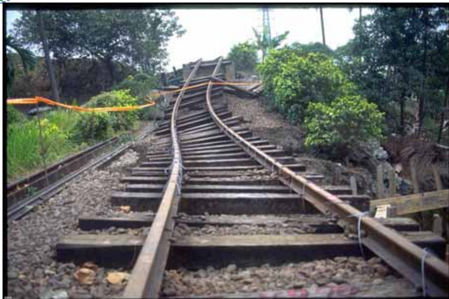
□ 南投縣名間鄉鐵軌嚴重變形(黃國鋒提供)
