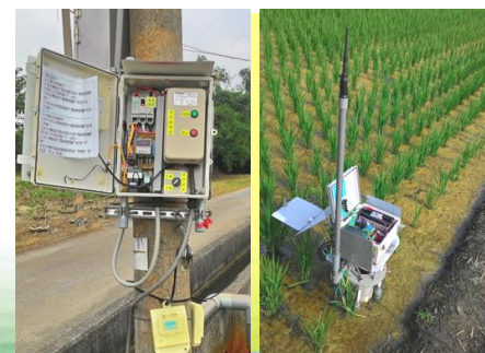
灌溉水深自動偵測設施
