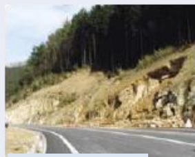
部分崩塌山坡面
