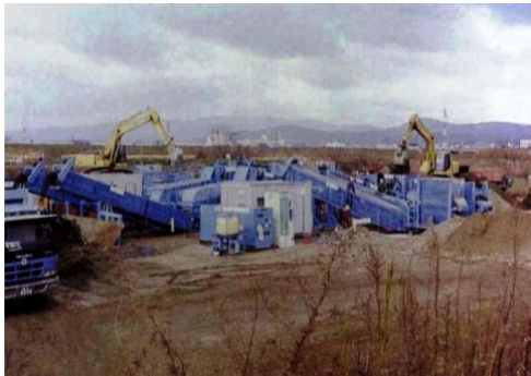
照片-1 設備全景
