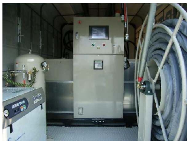
照片－2 發泡製造機
