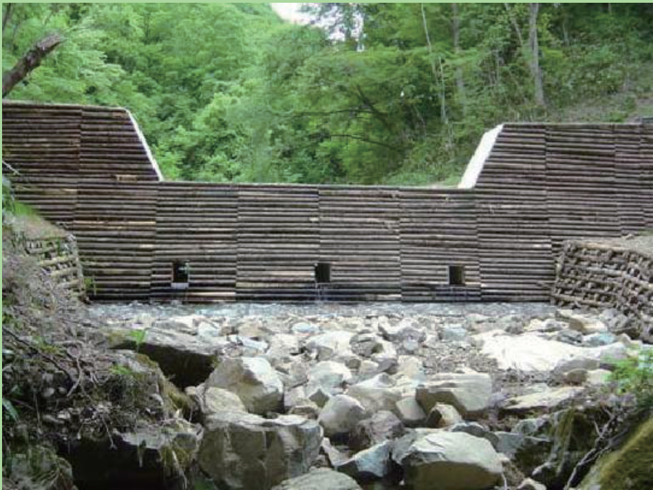
木面板防砂設施示意照片
