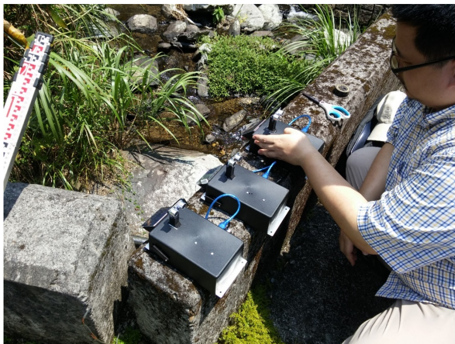
圖 2-23 現場安裝水位計
