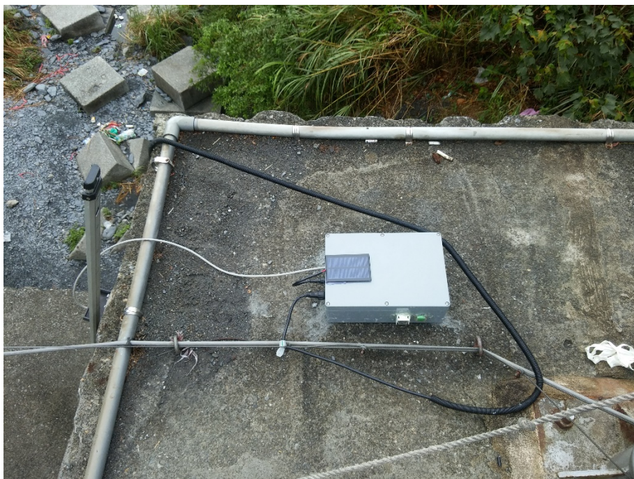
圖 2-35 寒溪改良式水位計處理器安裝完成圖
