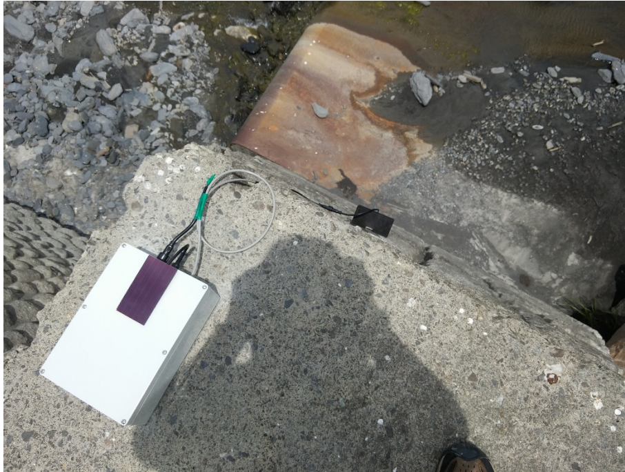
圖 2-36 碼崙 3 號壩改良式水位計安裝完成圖
