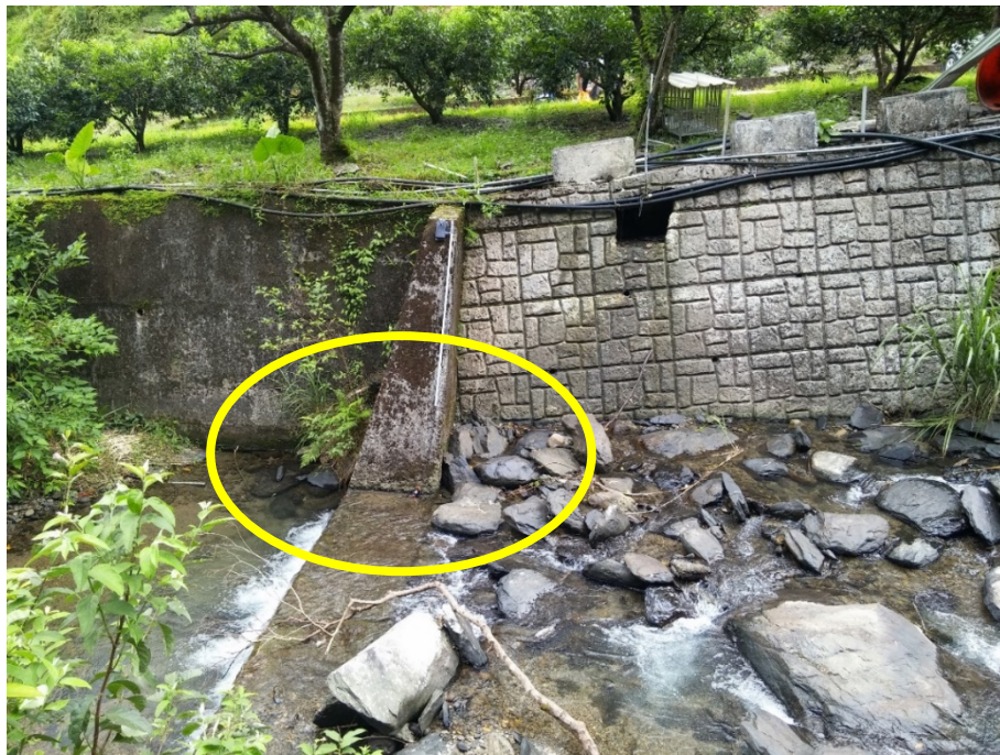
圖 2-29 崩山湖下游安裝微水力發電系統圖
