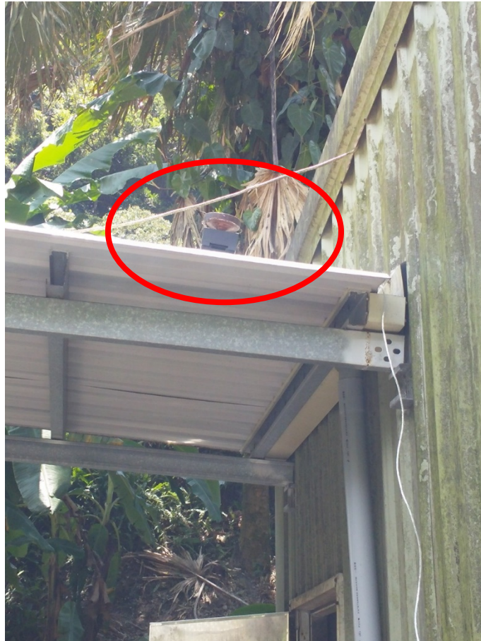
圖 2-22 雨量計安裝完成圖
