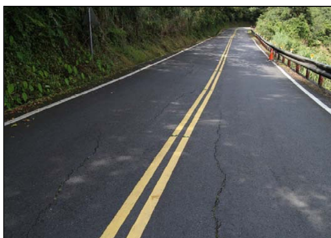
圖 1-4、蘭台地區宜專一線道路裂縫(寬約 3~5 公分、落差約 3 公分高)
