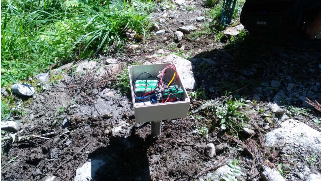
圖 4-29、設置完成的含水量計與無線通訊模組
