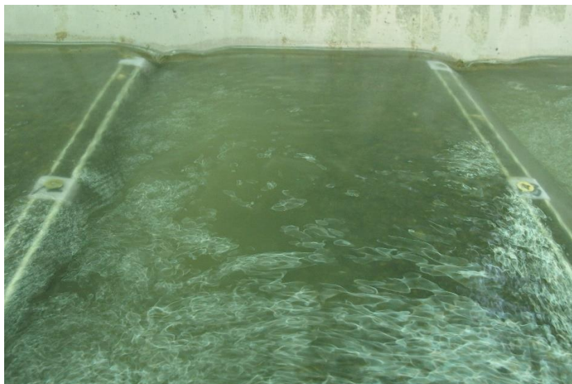
圖 4-17 水流溢淹漫過透水式 C 型固床工造成投潭的情形
