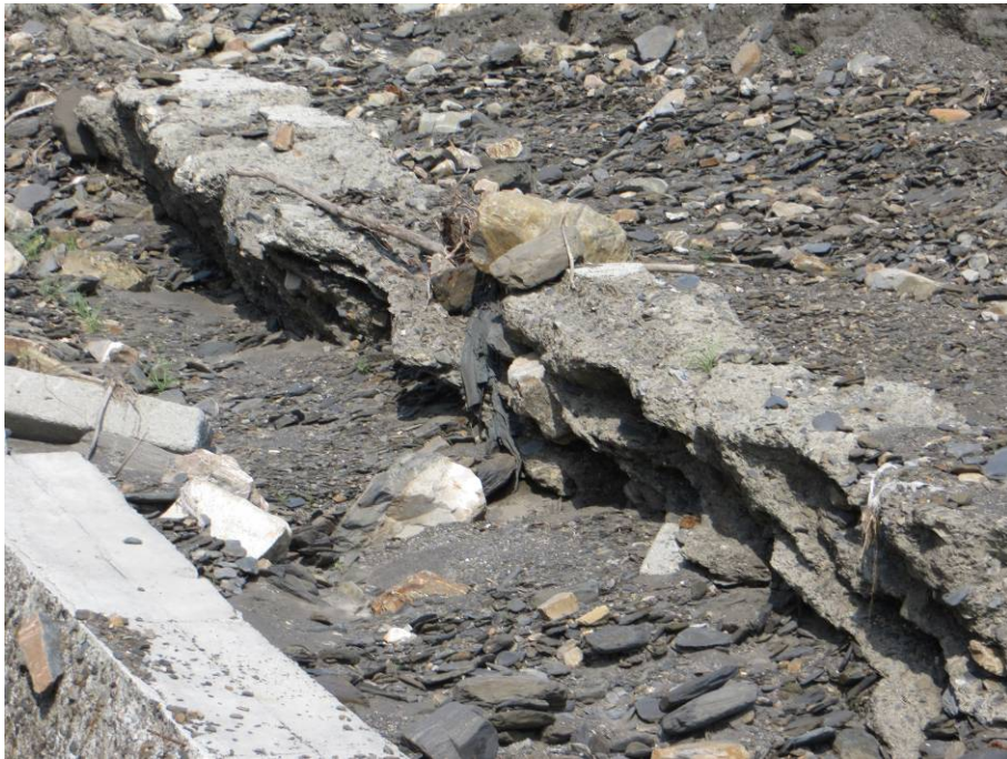
圖 3-31 合望溪殘存之野溪淤積混凝土構造物
