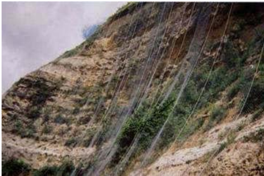
邊坡落石防護網
