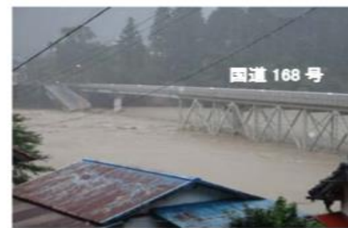
おりたち 写真 1.4 十津川村折立地区 河川の増水により、折立橋の一部が流され、落橋し、道路が寸断されました。
