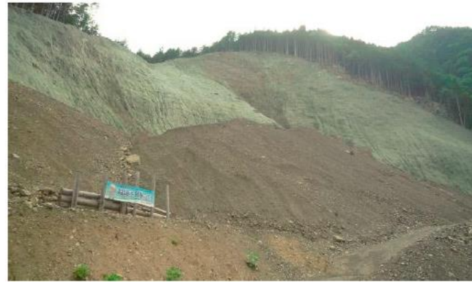
圖3-20 災害地現況，崩塌面施作護坡
