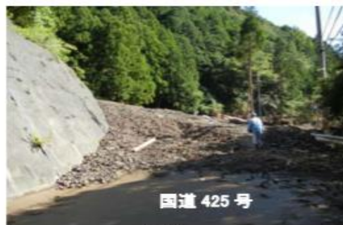
しげさと 写真 1.3 十津川村重里地区 土石流が道路上に多量に堆積し、道路が寸断されました。
