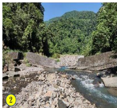
2 號壩現況 河床下切縱向冲刷，防砂設施 損壞，無防砂效益
