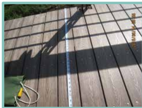
▲ 木棧平台未作溝槽防滑處理
