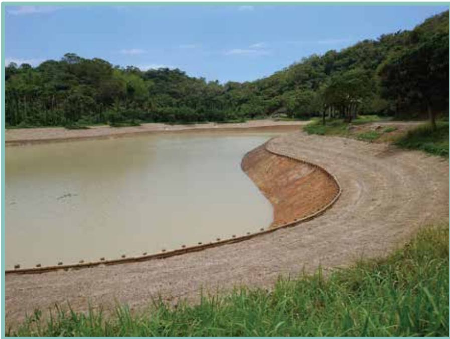
▲ 缺少欄杆、救生設備或危險警告標示等設施
