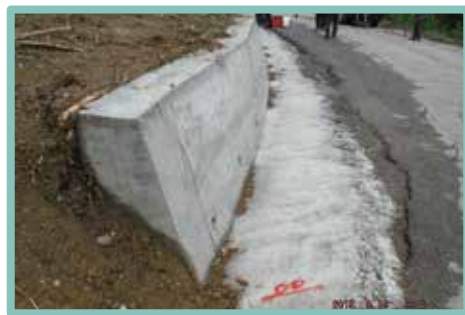
▲ 擋土牆未設結束工
