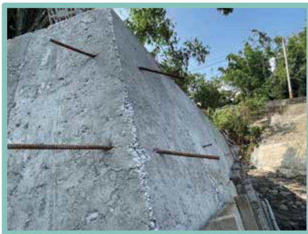
▲ 未清理綁紮模板螺桿
