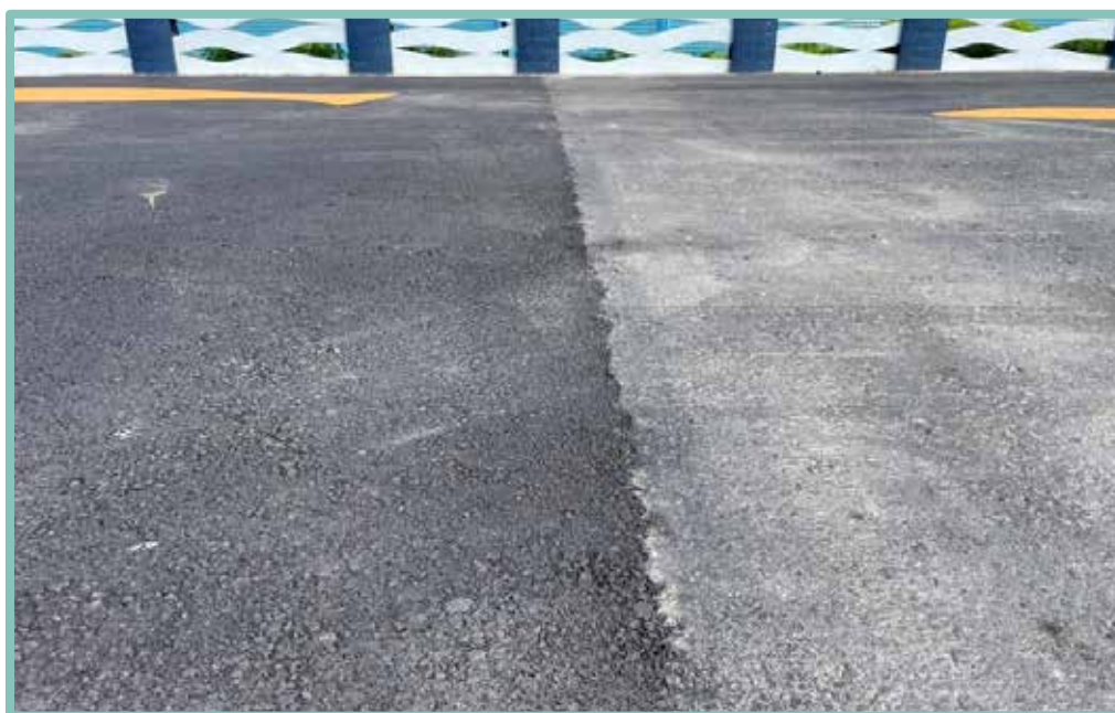
▲ 新舊界面未妥善處理
