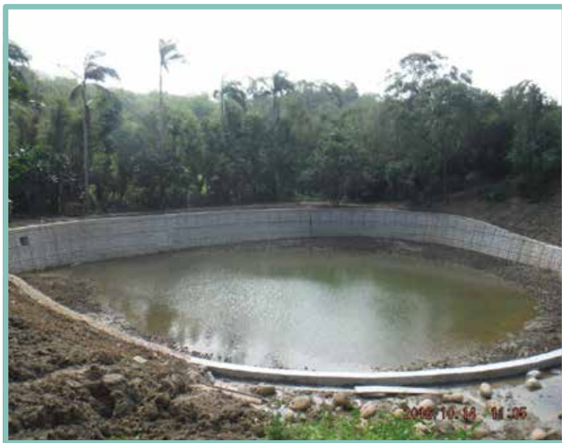
▲ 沉砂池周圍未設置欄杆、警示標誌等防護措施
