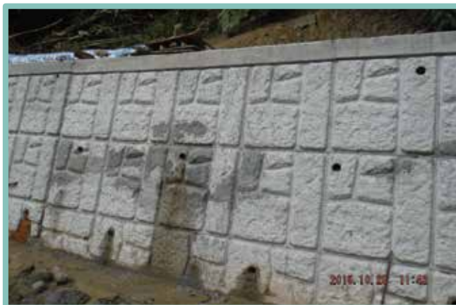
▲ 護岸洩水孔數量不足
