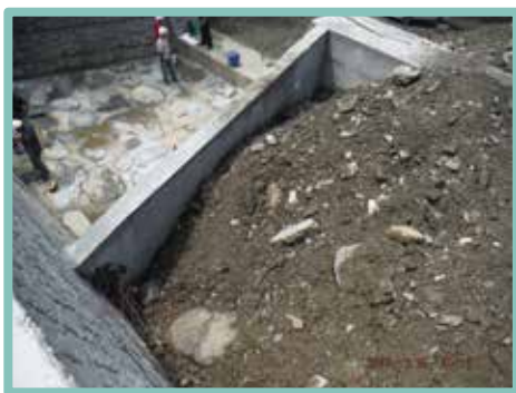
▲ 回填土方不足且未夯實
