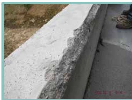
▲ 護欄混凝土尚未硬化而拆模破壞致鋼筋處
