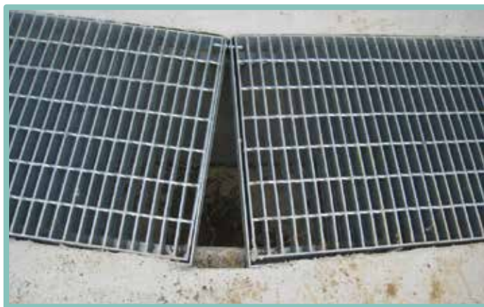
▲ 鍍鋅隔柵板轉彎缺漏蓋板
