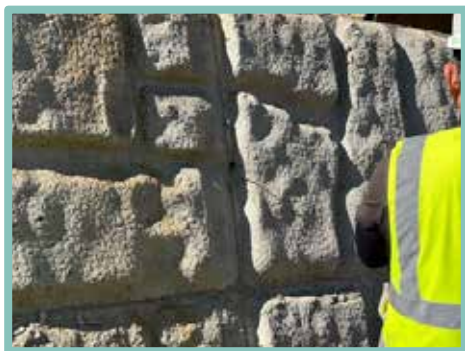
▲ 應設而未設洩水孔致數量不足
