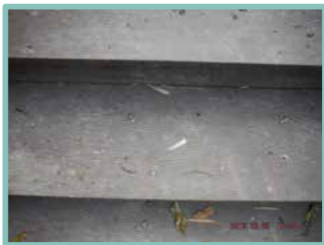
▲ 木棧階梯未作溝槽防滑處理
