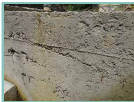
▲ 脫模劑不足淺槽混凝土表面凹凸不平
