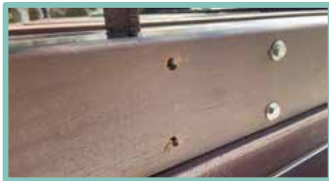
▲ 因五金零件錯鎖造成板材受損
