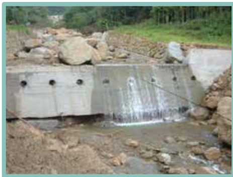
▲ 固床工基礎深度不足淘空
