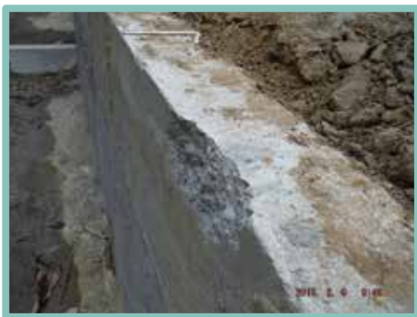
▲ 洩槽牆身遭外力撞擊破損缺角
