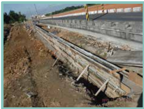
▲ 模板組立斜撐不足恐澆置爆模
