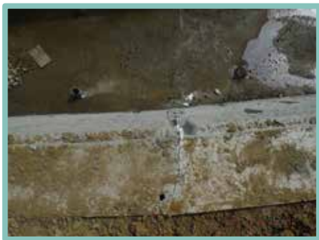
▲ 護岸伸縮縫歪斜
