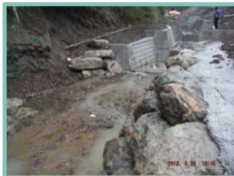
▲ 護岸終點未確實砌塊石
