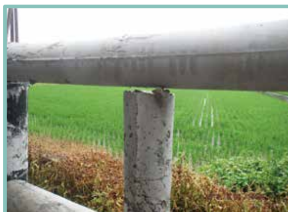
▲ 仿木欄杆銜接縫未填實
