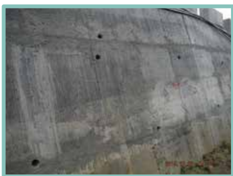
▲ 擋土牆洩水管排列過密
