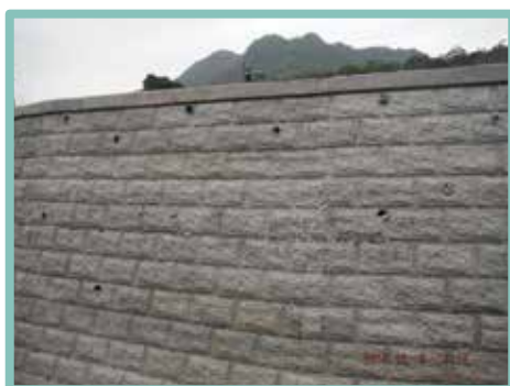
▲ 擋土牆洩水管排列間距不一且過高
