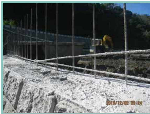
▲ 鋼筋綁紮未確實
