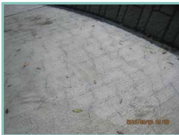
▲ 混凝土路面養護不足造成裂縫
