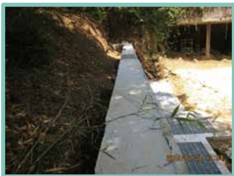
▲ 擋土牆背填處土方不足
