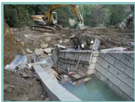
▲ 不當存放模板及餘料堆置河道處
