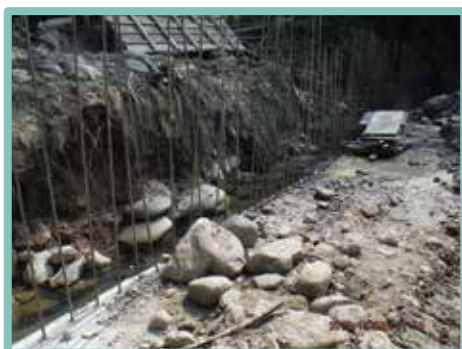
▲ 開挖 1.5m 未設臨時擋土支撐而崩落
