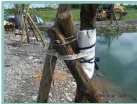
▲ 支架未圍繞喬木綁紮不正確
