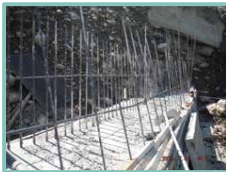
▲ 橫向鋼筋綁紮未確實而鬆脫
