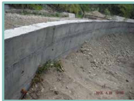
▲ 未設置濾水設施
