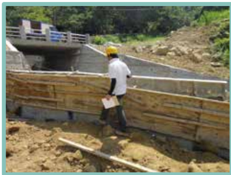
▲ 模板組立斜撐不足恐澆置爆模
