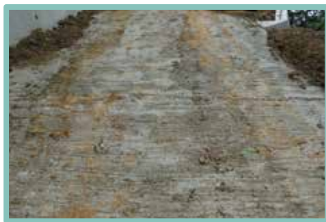
▲ 混凝土路面未鏟平與搗實不足呈現孔洞
