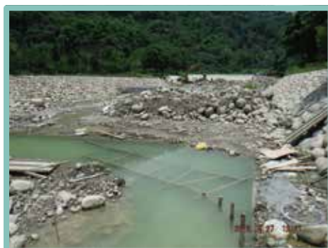
▲ 未適當導排水造成組模區位積水
