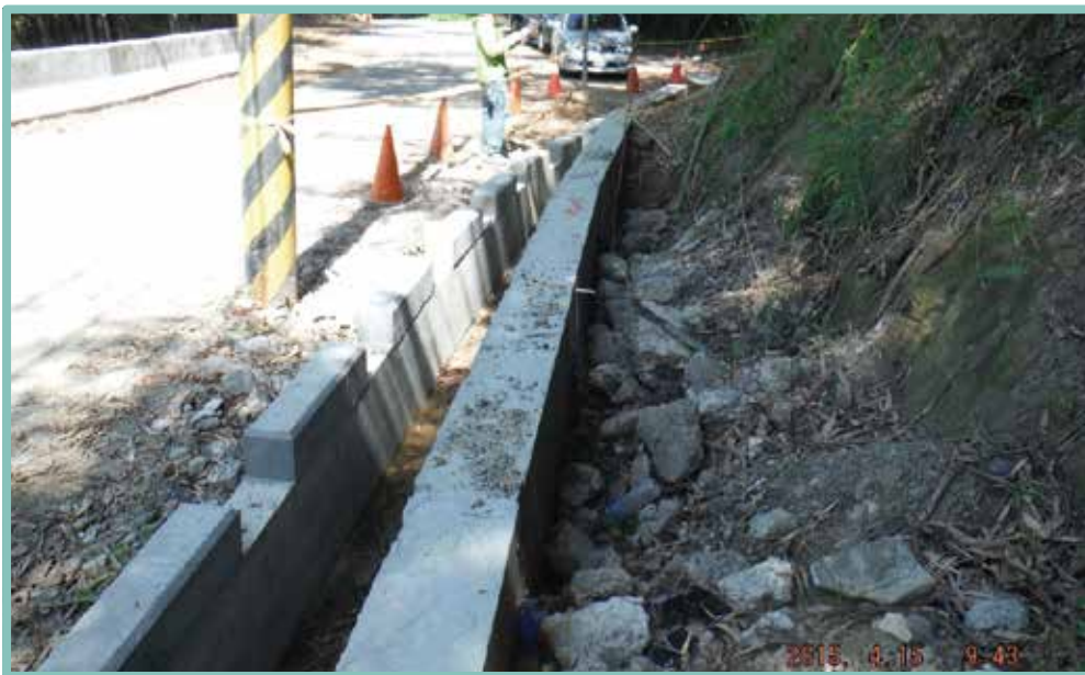
▲ 擋土牆背填處土方不足
