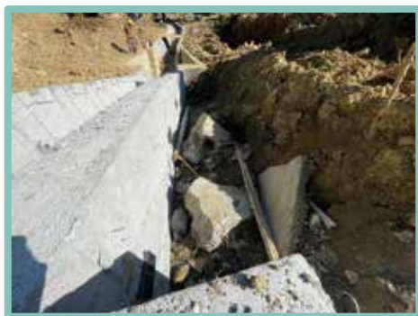
▲ 護岸背填處大量未破碎混凝土塊與植物殘枝
