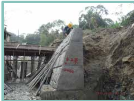
▲ 護岸起終點未設置端牆或結束工
