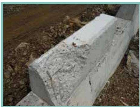
▲ 塊狀護欄混凝土尚未硬化而拆模破壞致鋼筋處
