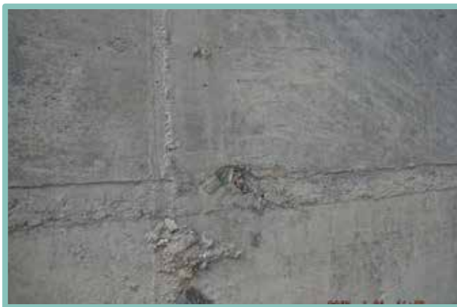
▲ 護岸洩水孔堵塞
