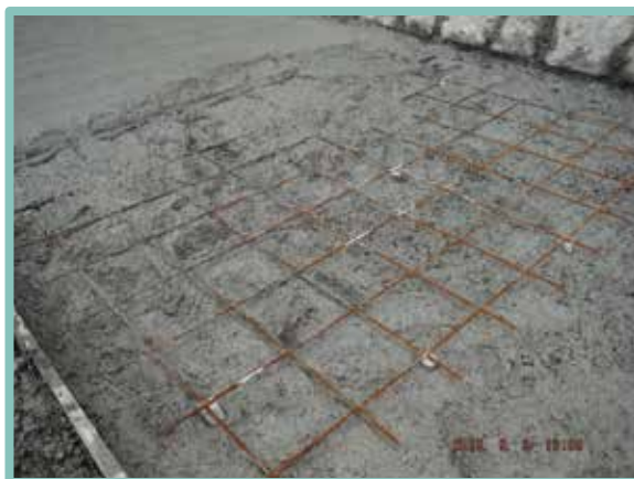
▲ 混凝土面澆置分層間隔時間過長
