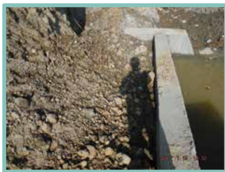
▲ 回填土方不足且未夯實
