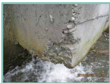
▲ 強力拆模造成豎井缺角
