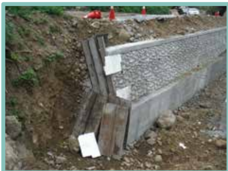
▲ 護岸起終點未設置端牆或結束工
