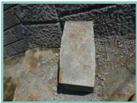
▲ 未妥善設置斜撐使混凝土完成面變形
