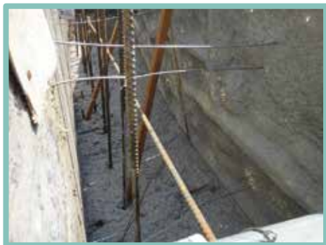
▲ 鋼筋未綁紮恐澆置位移
