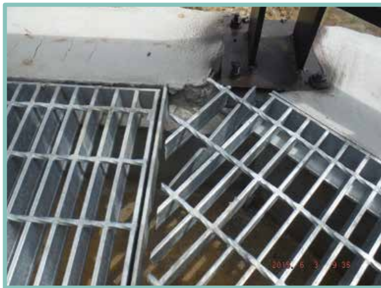
▲ 鍍鋅隔柵板折角處切割未完整
