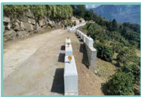
▲ 混凝土路面與塊狀護欄銜接不平順
