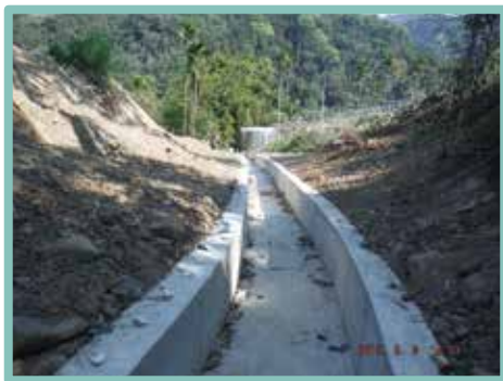
▲ 現場排水溝縱坡過陡應設計消能檻減緩流速
