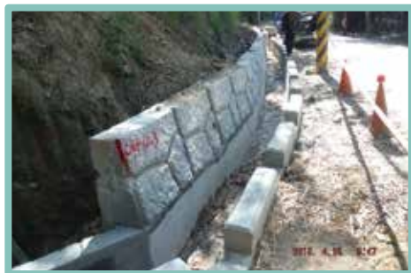
▲ 擋土牆未設結束工
