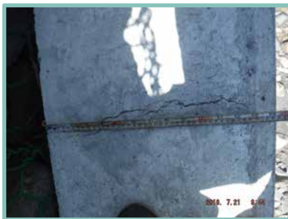
▲ 護岸未妥善養護造頂面裂縫
