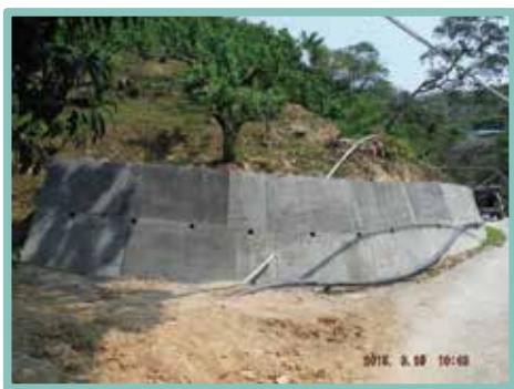
▲ 擋土牆模板組立不平順折角明顯
