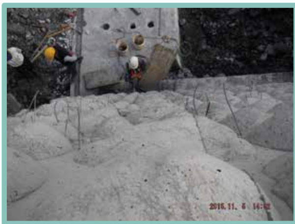
▲ 防砂壩壩翼混凝土表面鐵線未清理
