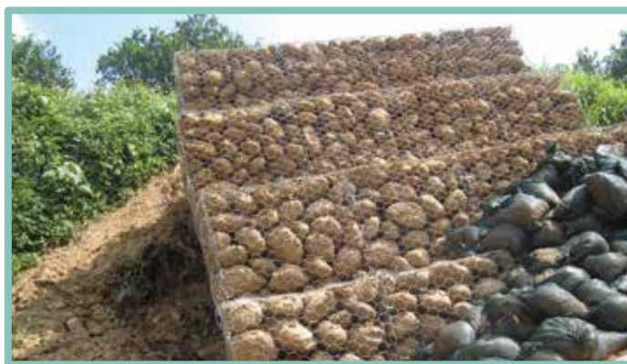
▲ 堆砌方式不正確因垂線交界面未錯開
