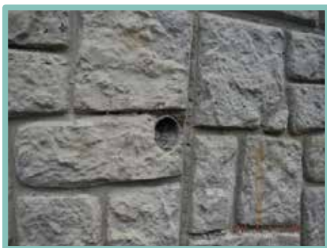
▲ 洩水管溢漿堵塞
