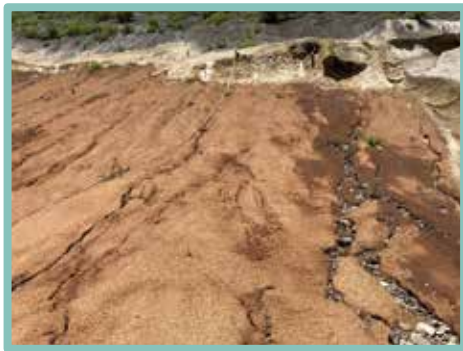
▲ 因截水設置不完善掛網噴植材部分流失
