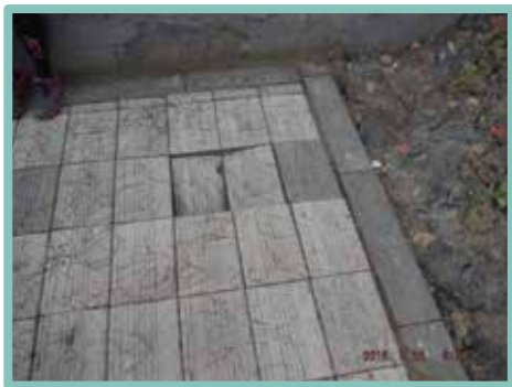
▲ 高壓磚不當沉陷
