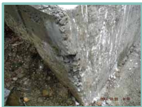
▲ 強力拆模造成塊狀護欄缺角
