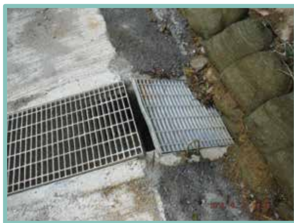
▲ 擋土牆 L 型溝與橫向排水銜接不當
