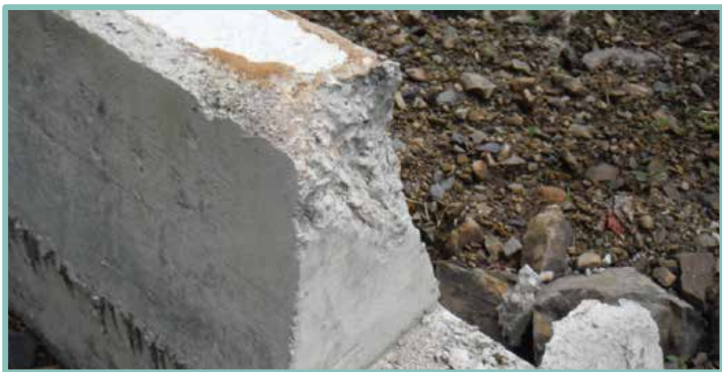
▲ 塊狀護欄遭外力撞擊破損缺角
