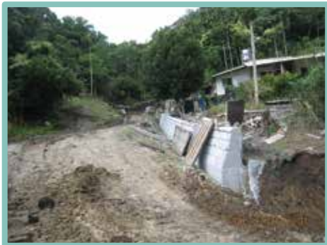
▲ 護岸終點未設置端牆或結束工
