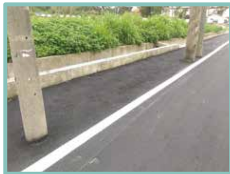
▲ 瀝青混凝土路面邊緣未滾壓呈現不同表面
