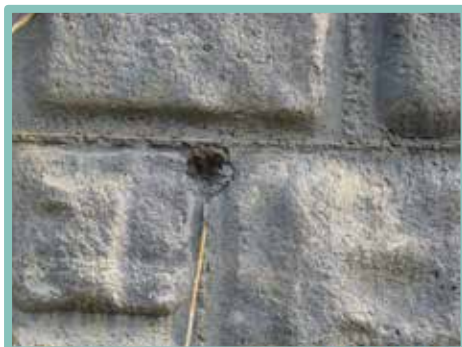
▲ 護岸洩水孔塞孔物未清理
