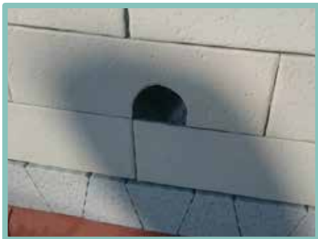
▲ 擋土牆美化工程遮阻洩水管
