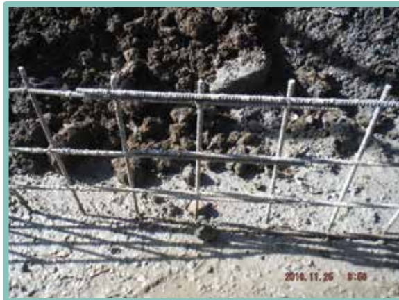
▲ 護岸牆身相鄰鋼筋搭接同一斷面
