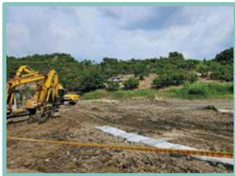
▲ 河道土質泥濘軟弱挖土機無法施工
