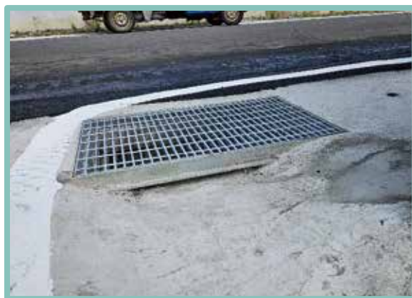
▲ 側溝與靜水池銜接不平順
