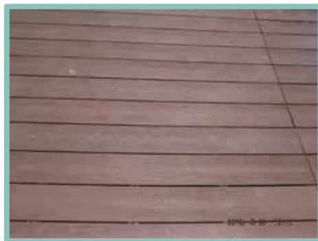
▲ 木棧平台未作溝槽防滑處理
