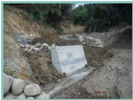
▲ 拆模立即回填恐影響構造物之穩定
