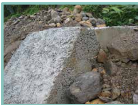
▲ 固床工翼牆處混凝土搗實未確實造成蜂窩
