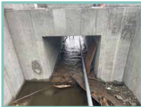
▲ 模板置於箱涵內恐降雨堵塞造成危害
