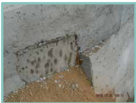
▲ 因模板品質差或脫模劑不足 使模板沾黏在混凝土表面
