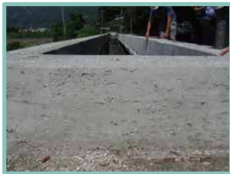
▲ 原模板釘孔多造成混凝土完成面突起
