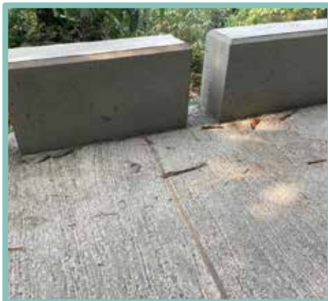
▲ 塊狀護欄座落在混凝土路面伸縮縫 恐難發揮伸縮縫功能
