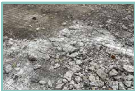
▲ 鋼筋組立前底層未清理
