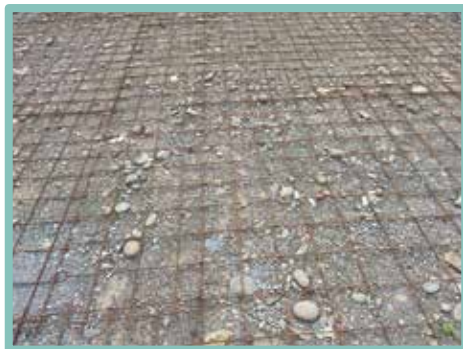
▲ 鋼筋底層未設置墊塊
