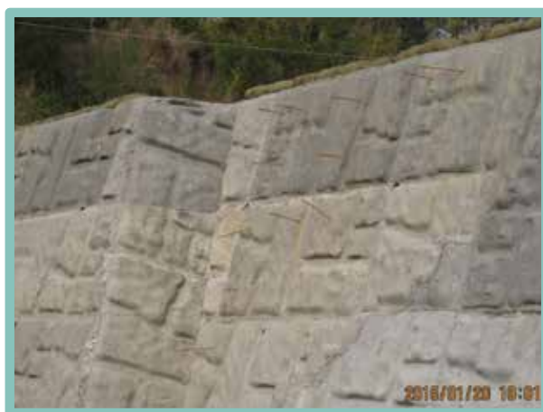
▲ 護岸混凝土表面螺桿未清理
