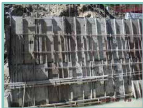
▲ 未經同意使用鋼筋模板組立
