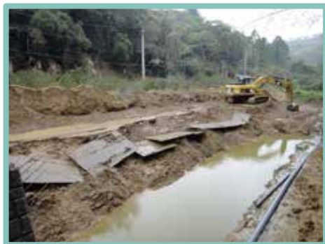
▲ 未適當導排水造成開挖區積水而土壤軟弱
