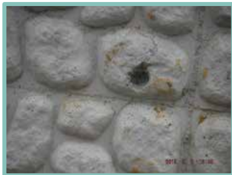
▲ 擋土牆洩水管溢漿阻塞
