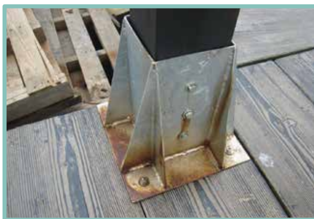
▲ 欄杆底座與五金零件銹蝕
