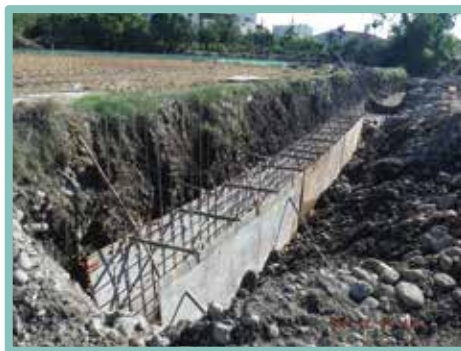
▲ 未經同意使用鋼板替代模板
