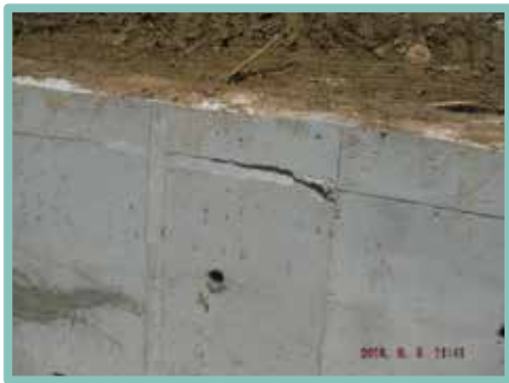
▲ 模板修補不當造成混凝土完成面凹陷
