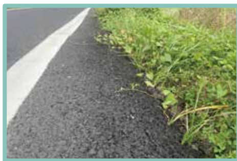
▲ 瀝青混凝土邊緣處未滾壓而鬆散
