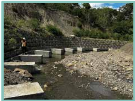
▲ 丁壩頂面斜率未斜向溪床恐未能發揮功能
