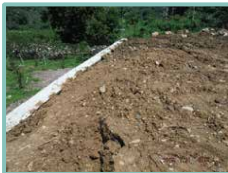
▲ 擋土牆背填處未修坡及夯實
