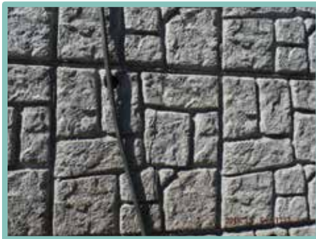
▲ 伸縮縫間距過大或未轉彎處增設而裂縫
