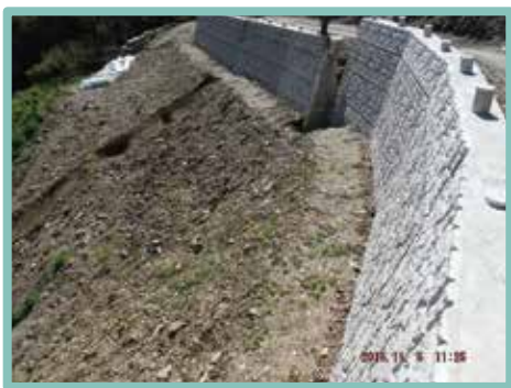
▲ 擋土牆銜接折角明顯
