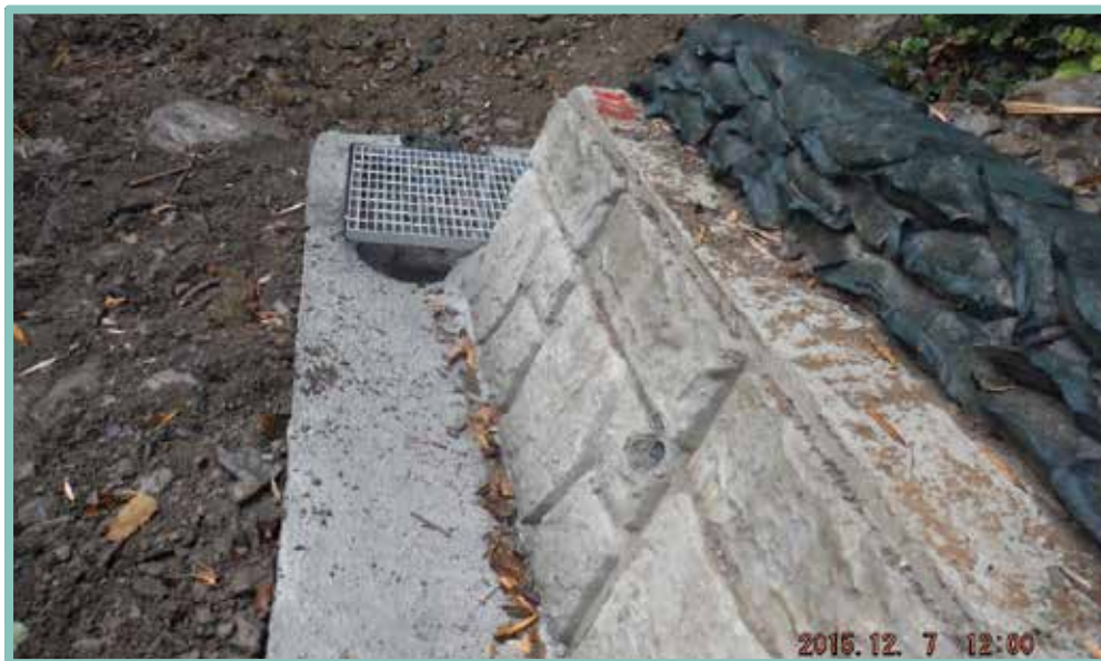
▲ 擋土牆 L 型溝與橫向排水銜接不當
