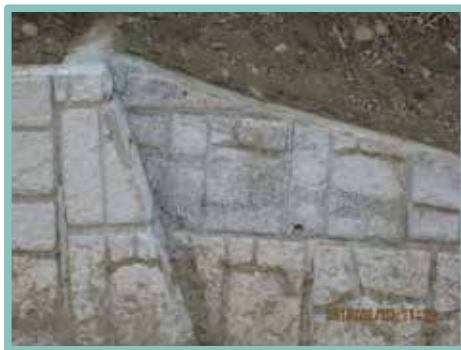
▲ 截牆混凝土搗實未確實造成蜂窩
