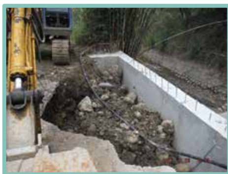
▲ 回填土方不足且未夯實
