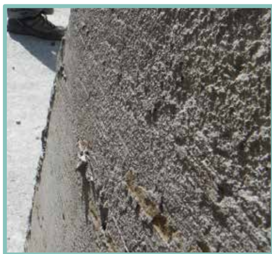
▲ 脫模劑不足混凝土表面明顯刮傷與缺角
