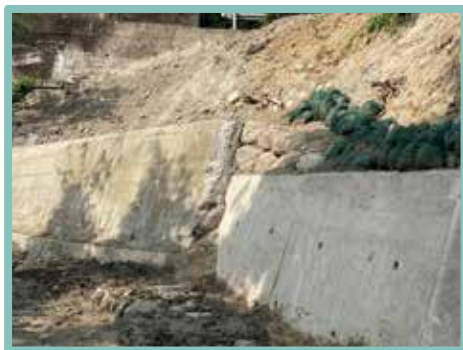
▲ 新舊擋土牆銜接不平順
