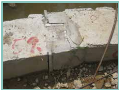
▲ 護岸僅以保麗龍施作施工縫有明顯裂隙
