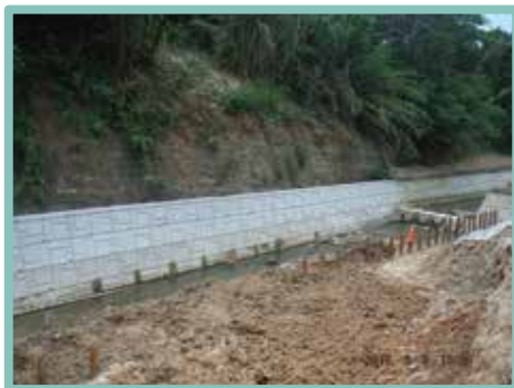
▲ 河道左岸臨時擋土支撐不足
