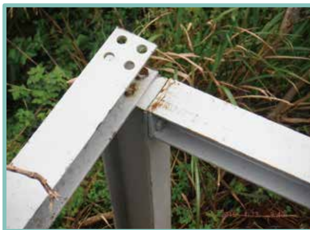
▲ 欄杆基座與五金零件銹蝕
