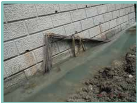
▲ 鋼筋堆置位置不當恐鋼筋鏽蝕
