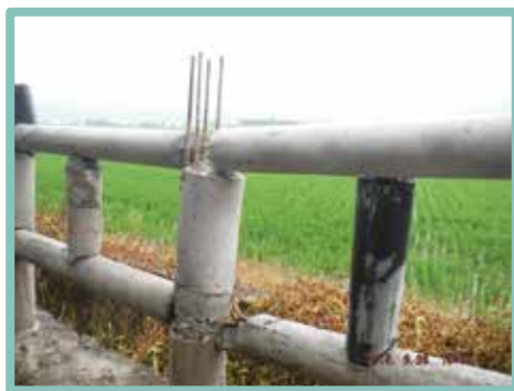
▲ 護欄垂向歪斜不順暢
