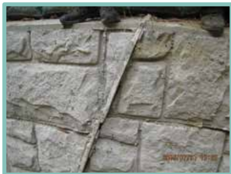
▲ 護岸伸縮縫歪斜
