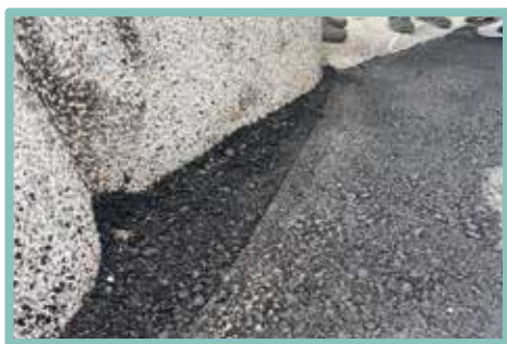
▲ 護欄瀝青混凝土邊緣處未滾壓
