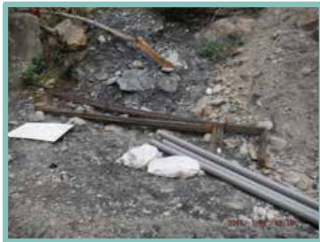
▲ 鋼筋堆置位置不當且未墊高
