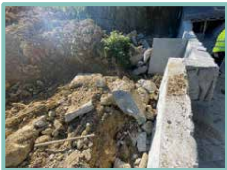
▲ 洩槽背填處大量未破碎混凝土塊
