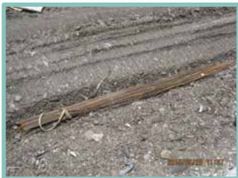
▲ 鋼筋堆置位置不當且未墊高
