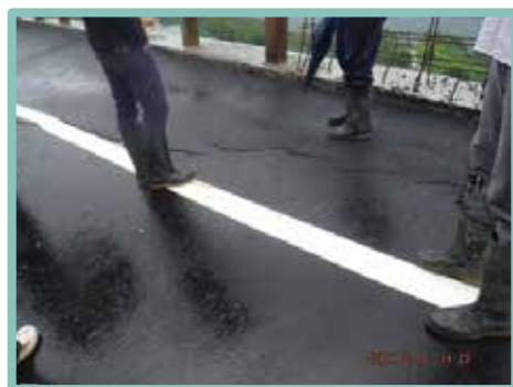
▲ 溫度不足或滾壓機速度過快 形成裂縫恐壓實度不足
