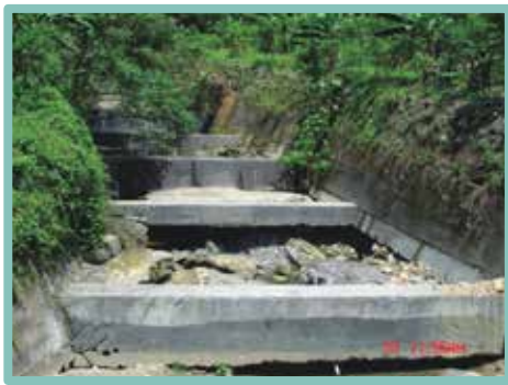
▲ 固床工基礎深度不足淘空
