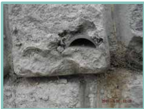
▲ 護岸洩水孔溢漿堵塞
