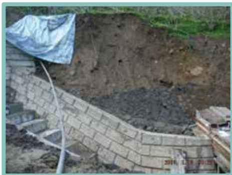
▲ 未設置臨時擋土支撐
