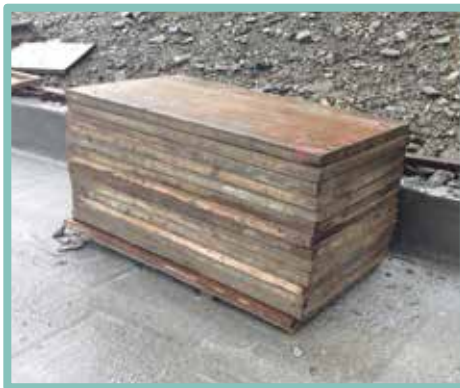
▲ 模板未以帆布遮蓋恐雨淋吸水變形
