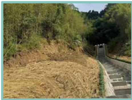
▲ 開挖過當破壞原始坡面
