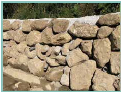
▲ 漿塊石護岸圍砌方式不正確
