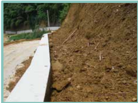
▲ 回填處土方未依規定方式施工
