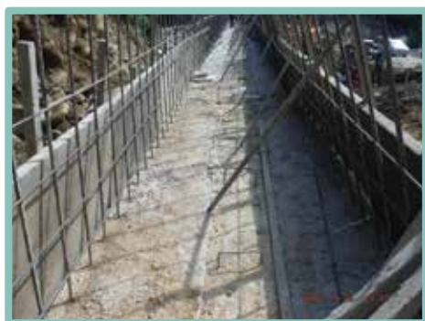
▲ 施工縫內土砂與垃圾影響作用
