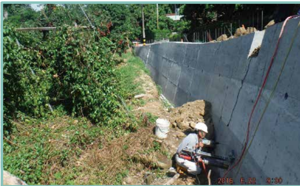
▲ 擋土牆澆置後未鏟平頂面線形成波浪狀
