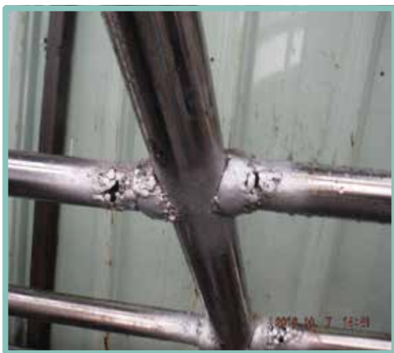
▲ 護欄焊接不當並加強防鏽
