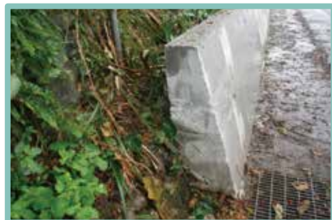
▲ 擋土牆未設結束工
