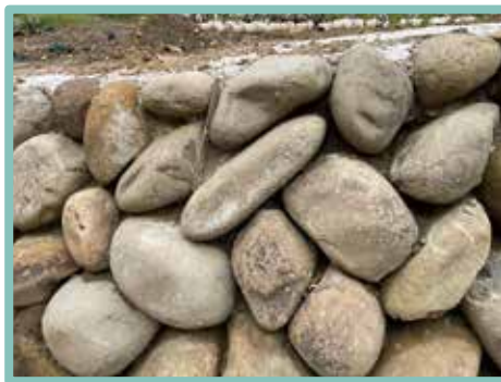
▲ 混凝土卵石未將長徑垂直坡面
