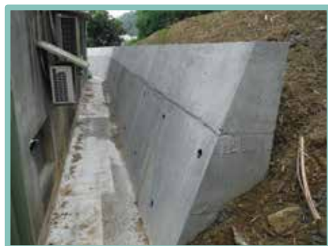
▲ 擋土牆未設結束工
