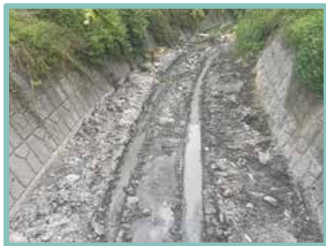
▲ 河道土質泥濘軟弱無法施工
