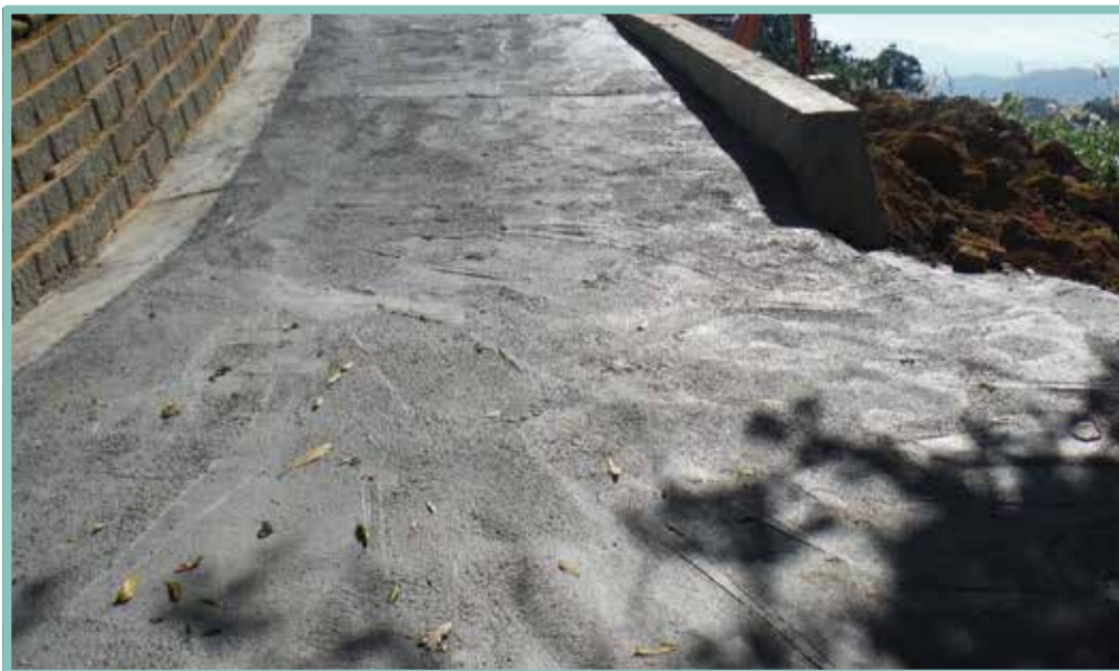
▲ 下邊坡與路面銜接不平順恐使用路人危害
