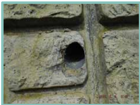
▲ 洩水管壁厚不足以致澆置變形
