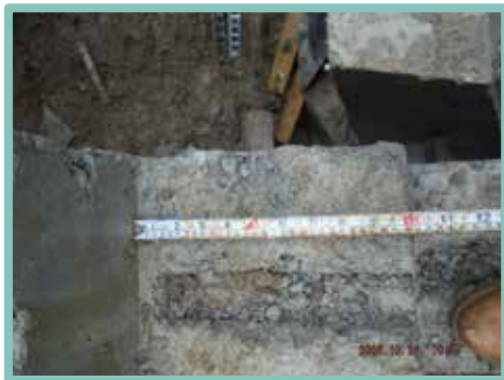
▲ 施工縫內土砂雜質多影響作用
