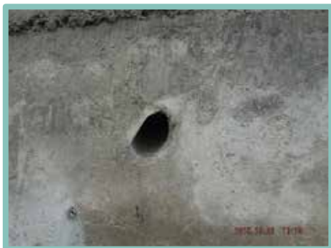
▲ 洩水管壁厚不足以致澆置變形
