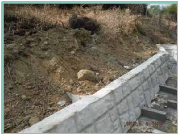
▲ 回填土方不足
