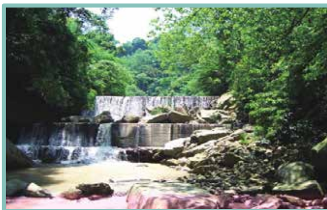
▲ 連續固床工未設置消能設施
