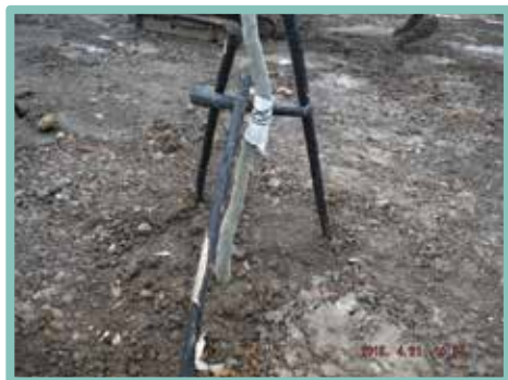
▲ 支架數量不足
