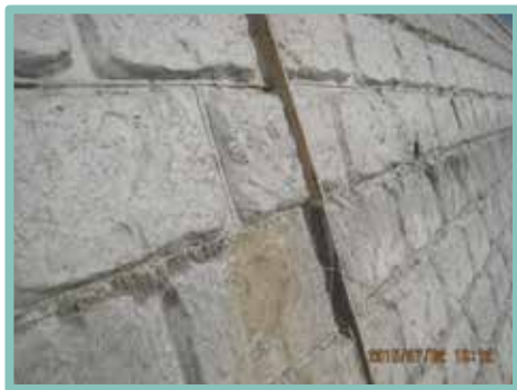
▲ 護岸僅以三夾板施作施工縫
