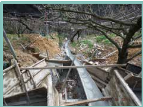
▲ 混凝土澆置傾洩過長易造成粒料分離
