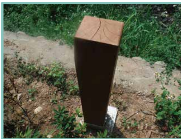
▲ 木材欄杆開裂應更換重新施工
