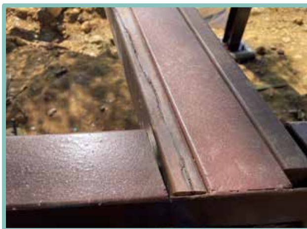
▲ 木棧銜接欄杆木材開裂
