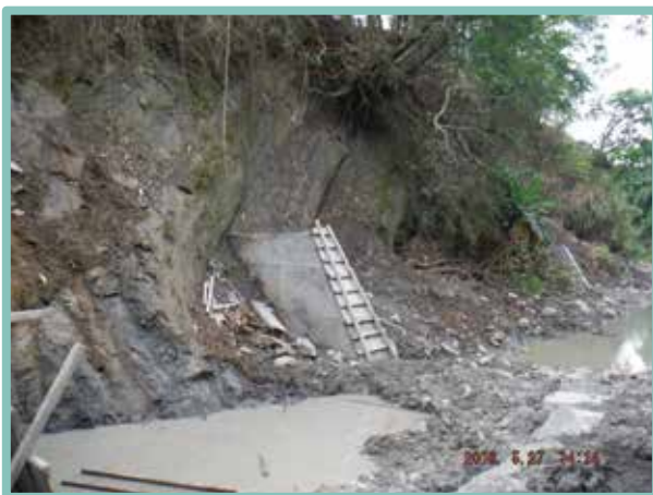
▲ 開挖壩基礎無岩盤或土壤呈現軟弱
