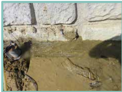
▲ 與護岸銜接面未預留鋼筋
