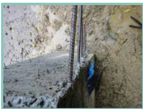
▲ 鋼筋保護層不足
