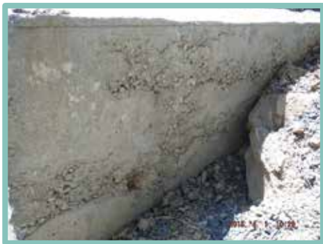
▲ 護岸混凝土搗實未確實造成蜂窩
