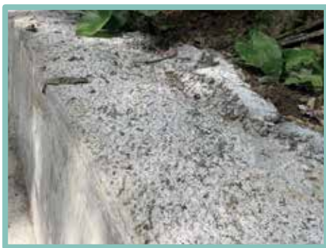
▲ 擋土牆澆置完成後未頂面鏟平呈凹凸狀
