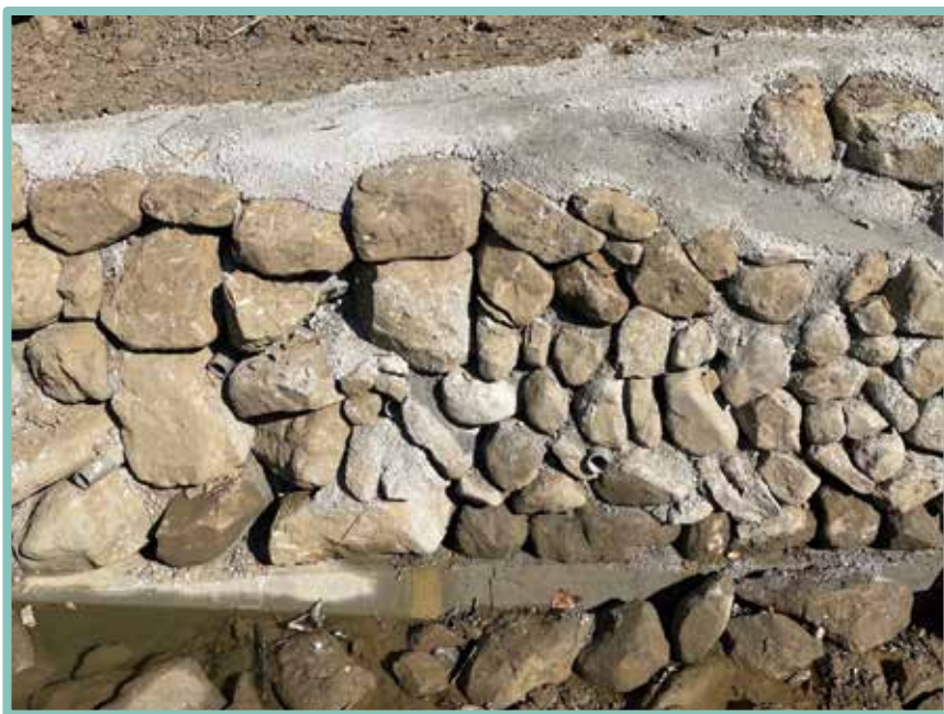
▲ 塊石尺寸與質地較差砌築後明顯破損
