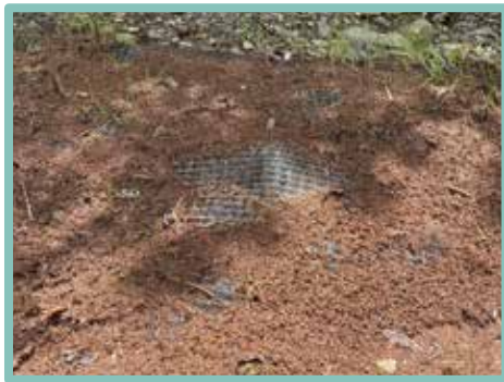
▲ 噴植厚度不足披覆網材裸露
