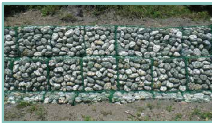
▲ 箱籠擋土牆堆砌垂線交界面未錯開
