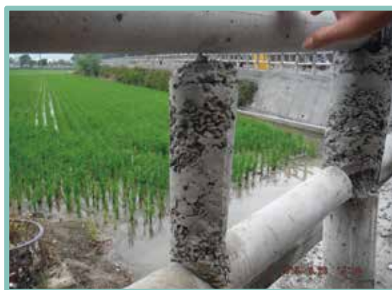
▲ 仿木欄杆混凝土澆置表面明顯蜂窩
