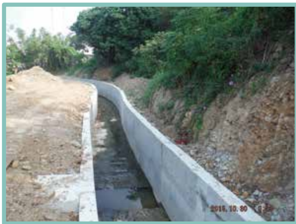
▲ 回填土方不足以形成溝外溝
