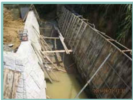
▲ 模板支撐數量不足
