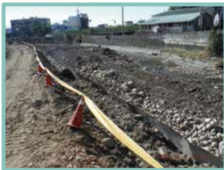
▲ 未經同意使用鋼板替代模板
