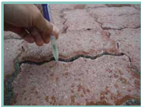
▲ 高壓磚高程不平順恐造成用路人危害
