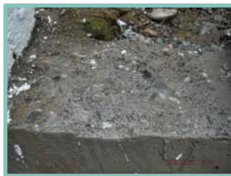
▲ 護岸頂面未鏟平
