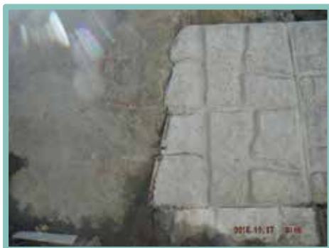
▲ 新舊擋土牆銜接不平順
