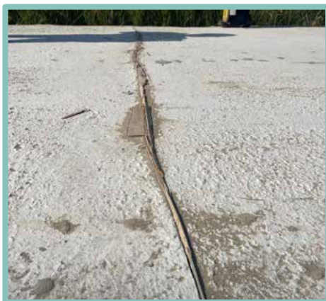
▲ 混凝土路面伸縮縫歪斜
