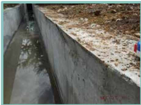
▲ 模板組立支撐不足使混凝土上端斜率不符
