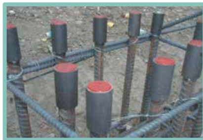
▲ 鋼筋續接處綁紮未牢固
