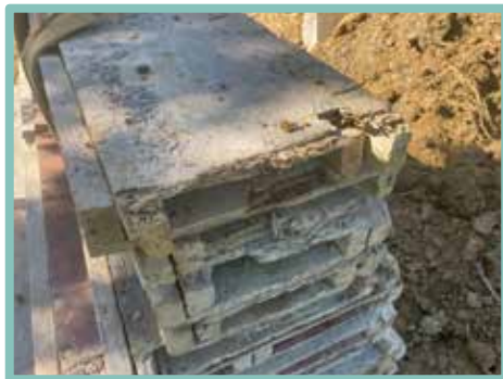
▲ 模板嚴重破損要求運離工地不得使用
