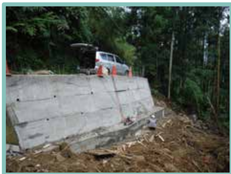
▲ 模板組立斜撐不足造成上面混凝土表面錯動
