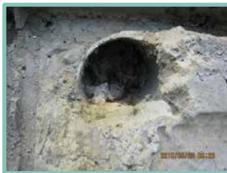
▲ 洩水管溢漿堵塞
