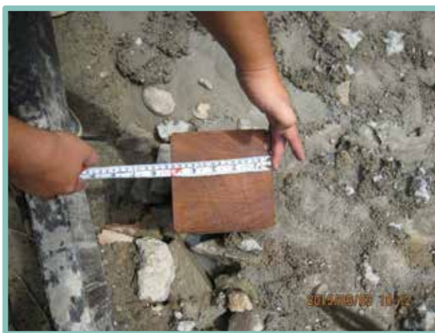
▲ 木製桿件切割未塗防腐、防蟲、防蟻塗料
