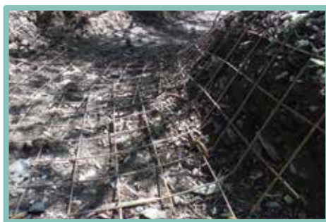
▲ 點焊鋼筋網底層未清理有機質
