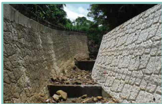
▲ 固床工未設置消能設施
