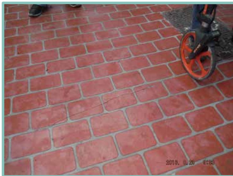
▲ 壓花地坪養護不足造成裂縫
