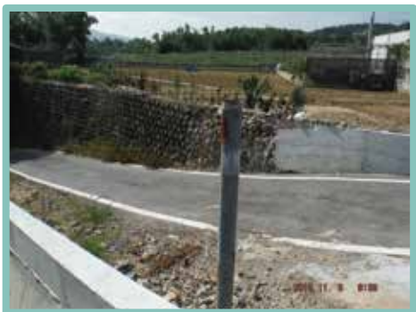
▲ 新舊擋土牆銜接不平順有凸起狀
