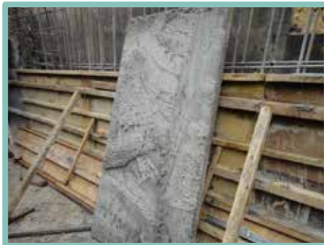
▲ 模板表面混凝土殘渣未清理
