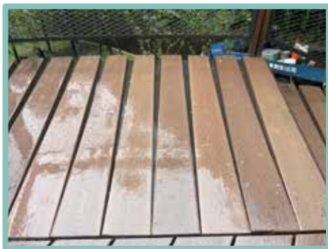
▲ 木棧平台未作溝槽防滑處理
