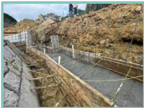
▲ 鋼筋未設置鋼筋間隔器
