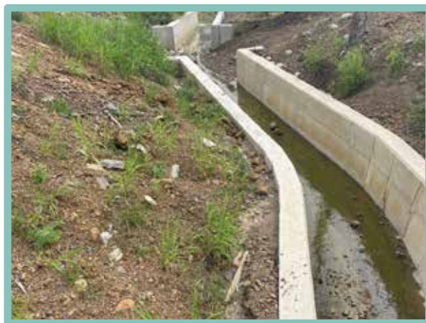
▲ 洩槽背填處回填土方不足形成溝外溝
