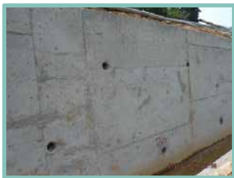
▲ 洩水管擺設於施工縫易造成混凝土構造物弱面
