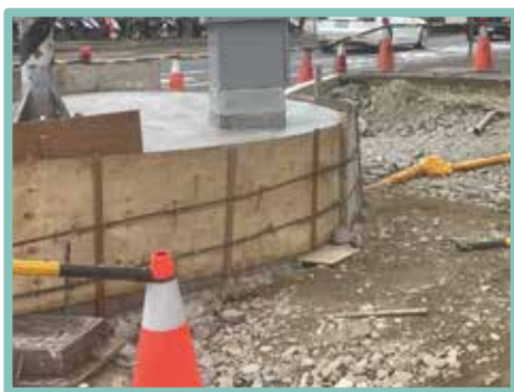
▲ 未經同意使用鋼筋作為模板支撐材 以致澆置構造物變形
