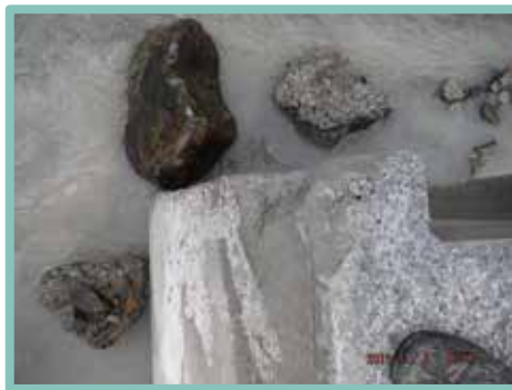
▲ 固床工遭外力撞擊破損缺角
