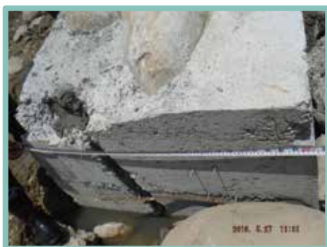
▲ 垂向施工縫內土砂多影響作用
