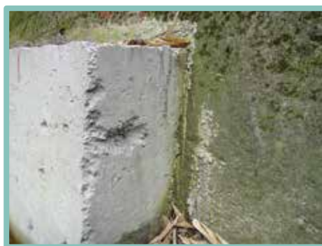
▲ 強力拆模拉拔鐵絲造成護岸基礎缺角凹洞
