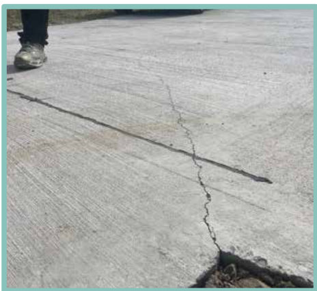
▲ 混凝土路面伸縮縫長度不足
