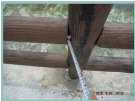
▲ 仿木欄杆銜接縫未填實
