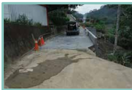
▲ 下邊坡銜接不平順恐使用路人危害
