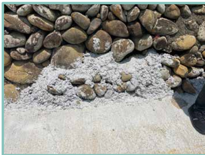
▲ 漿砌卵塊石擋土牆大量混凝土外漏
