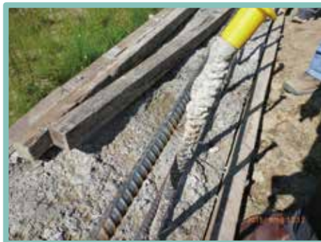
▲ 鋼筋綁紮未確實而鬆脫
