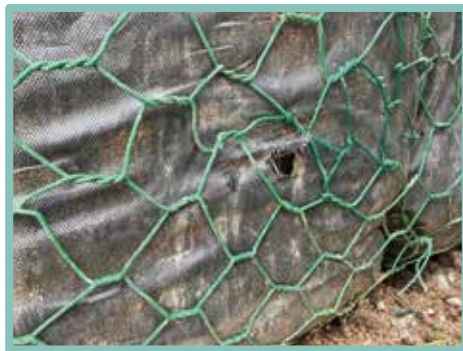
▲ 堆疊施工拉扯鍍鋅鐵絲變形
