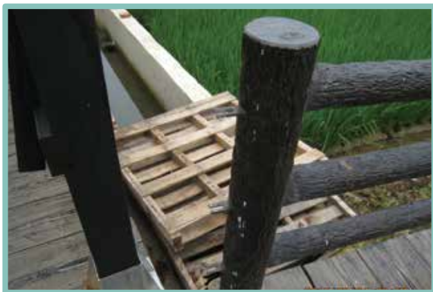
▲ 仿木欄杆銜接五金零件不良
