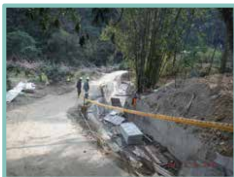
▲ 不當存放模板堆置河道處
