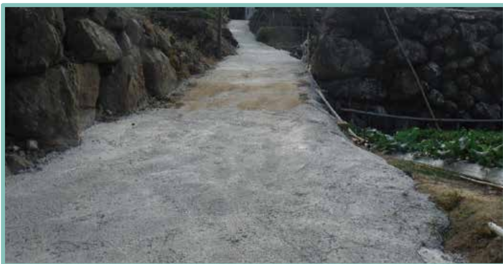
▲ 混凝土路面未鏟平與搗實不足呈現孔洞
