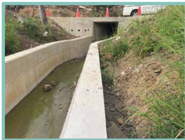
▲ 洩槽背填處回填土方不足影響匯集逕流
