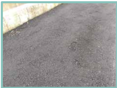
▲ 滾壓不足路面呈機械壓痕
