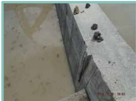
▲ 模板組立尺寸不足以致混凝土完成面突出
