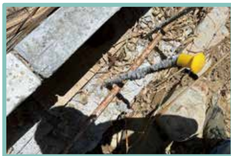
▲ 鋼筋組立完成後內含大量枯枝落葉
