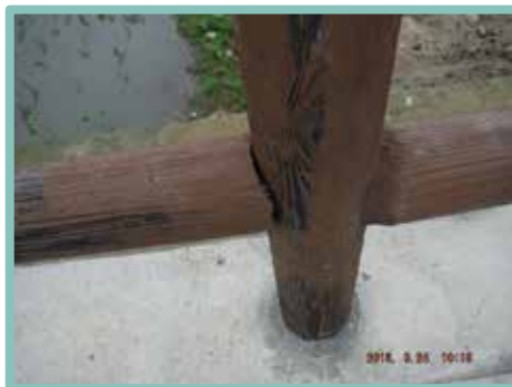
▲ 仿木欄杆銜接縫未填實
