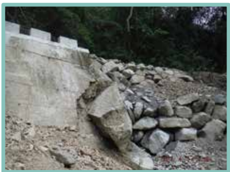
▲ 新舊擋土牆銜接不平順
