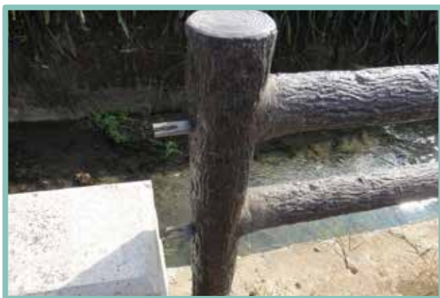
▲ 仿木欄杆銜接五金零件不良
