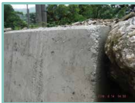
▲ 強力拆模造成護岸端牆缺角
