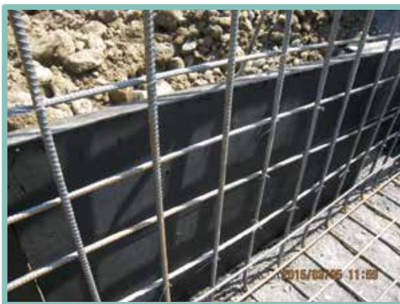
▲ 鋼筋綁紮未確實
