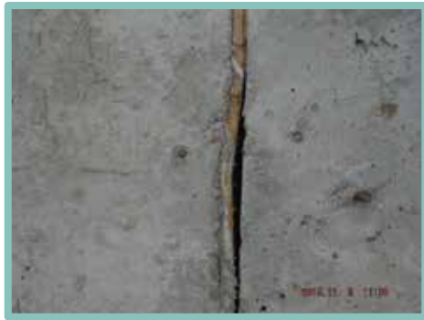
▲ 僅以三夾板施作施工縫因混凝土乾縮而裂隙
