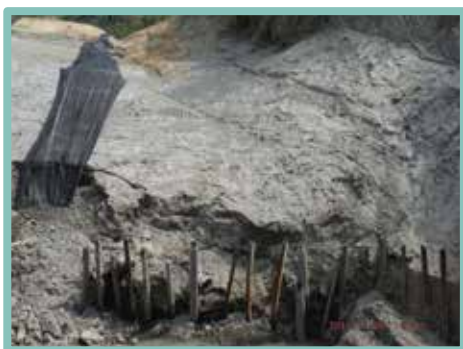
▲ 上邊坡崩落處臨時擋土支撐不足
