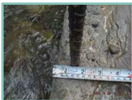
▲ 鋼筋保護層不足
