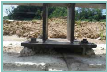
▲ 安裝基座未能伏貼恐有安全之虞
