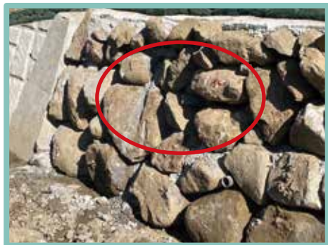
▲ 部分洩水管倒斜無法排水
