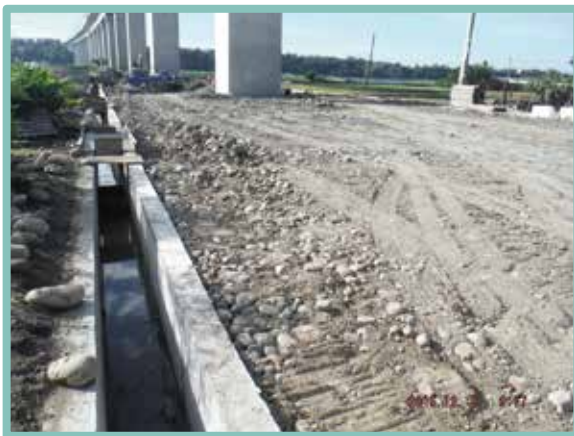
▲ 底層未整平及夯實
