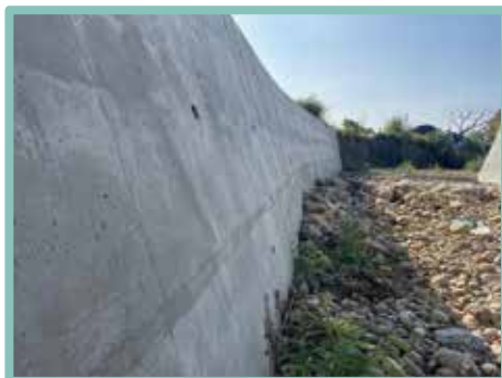
▲ 模板支撐不足以致混凝土完成面突出
