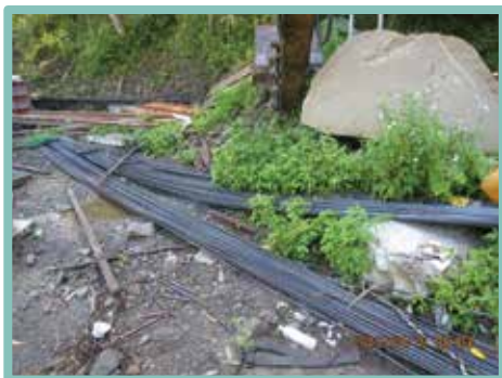
▲ 鋼筋堆置位置不當且未墊高
