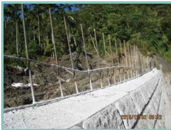
▲ 鋼筋綁紮未確實
