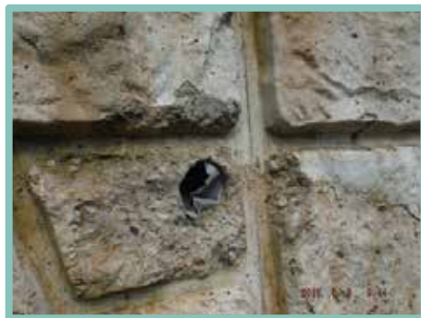
▲ 洩水管壁厚不足以致澆置變形
