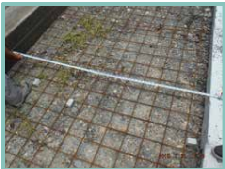
▲ 點焊鋼絲網底層墊塊設置不佳保護層不足
