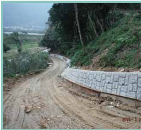
▲ 地層土壤未夯實現場明顯車轍
