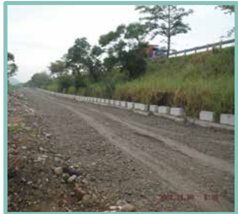
▲ 地層土壤未夯實現場明顯車轍
