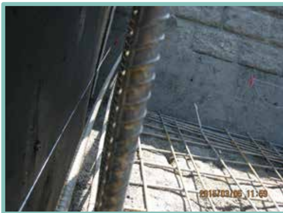
▲ 鋼筋未綁紮恐澆置位移
