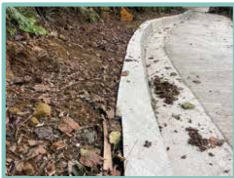
▲ 模板組立尺寸不正確以致混凝土完成面交錯
