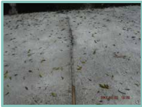
▲ 混凝土路面伸縮縫位移
