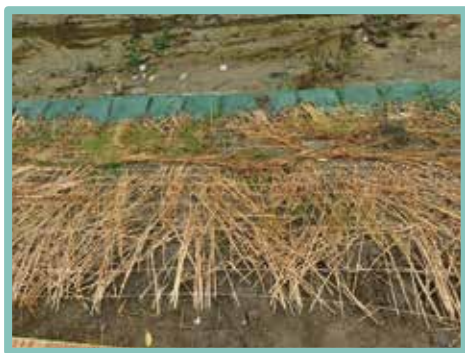
▲ 稻草席鋪設過於鬆散 且排列方向應稻稈垂直坡向
