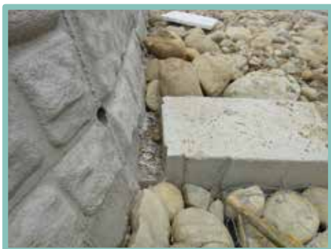
▲ 與護岸銜接面未預留鋼筋
