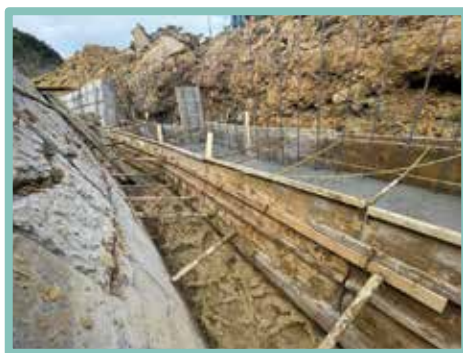
▲ 模板支撐數量不足
