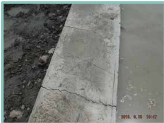
▲ 護岸未妥善養護造成頂面裂縫
