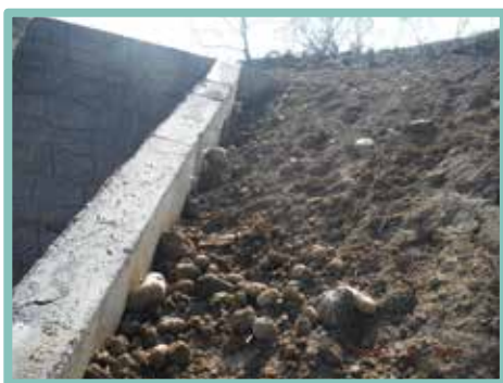
▲ 回填土方不足且未夯實
