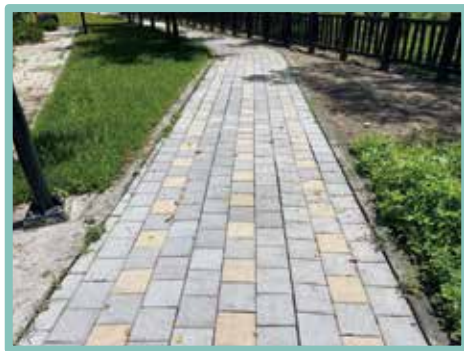
▲ 高壓磚不當沉陷
