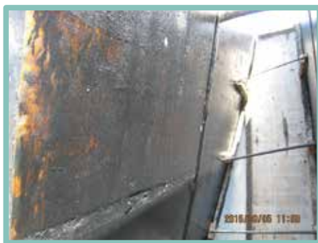
▲ 模板表面脫模劑未均勻且未採用規定之脫模劑
