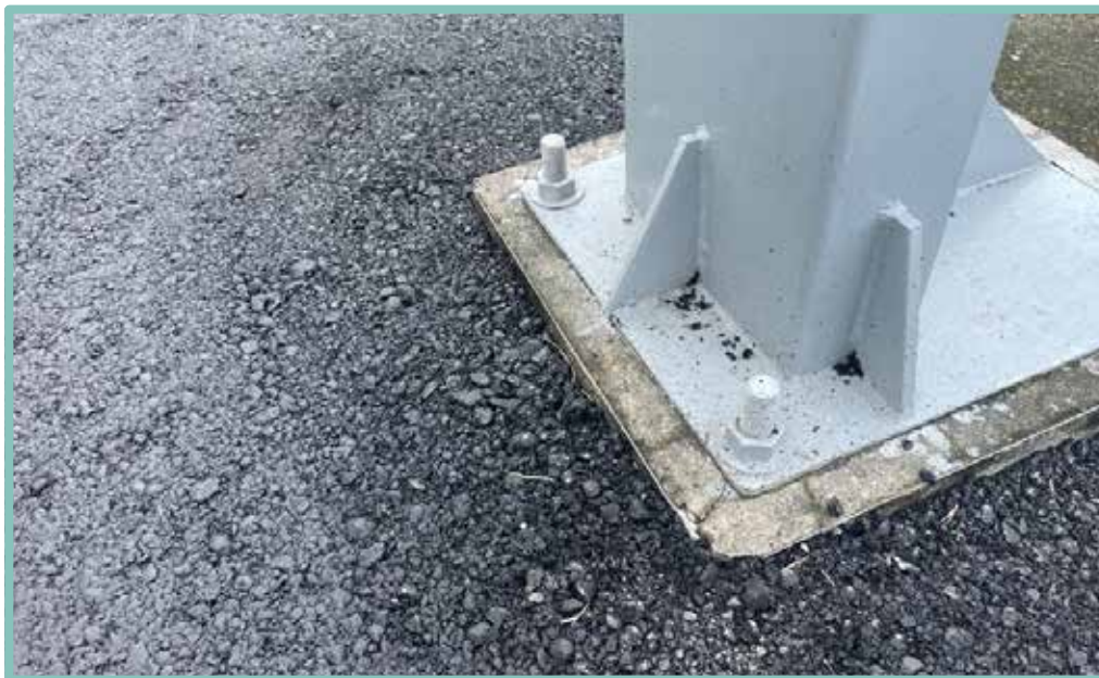
▲ 基座周圍瀝青混凝土未確實夯實
