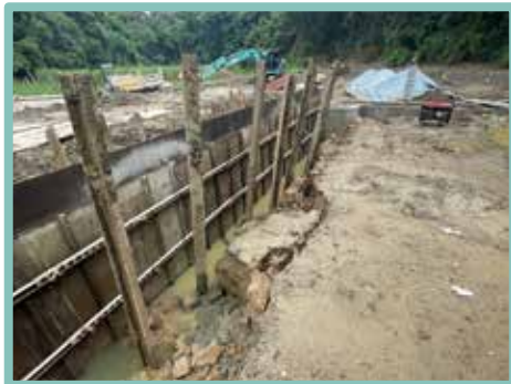
▲ 臨時擋土支撐不足
