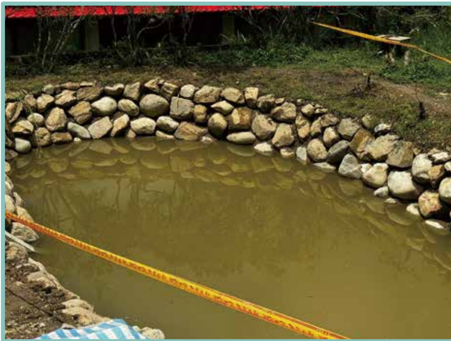
▲ 築砌石材未挑選且為砌方式不符規定
