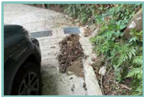
▲ L 型溝與路面設置不當
