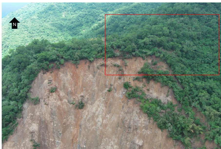
圖 6 崩塌頂部裂隙現況 (拍照日期 113/10/9)
