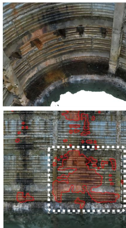
井體劣化評估
