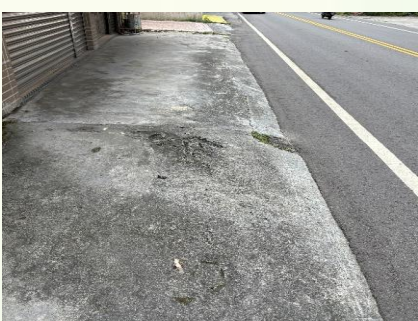
道路路面高低落差
