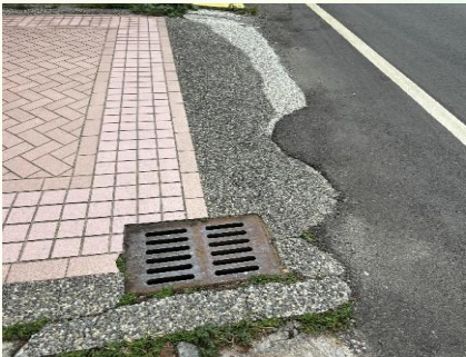
道路路面不平整
