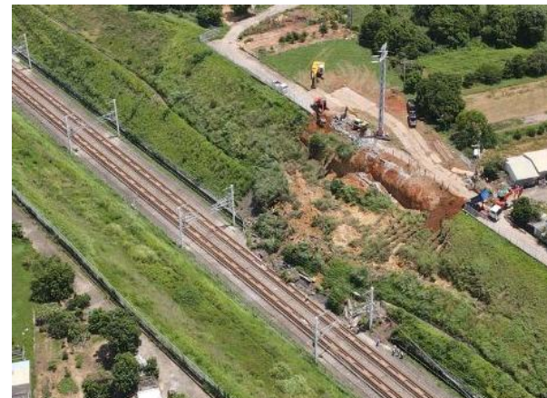
110年TK126邊坡坍塌
