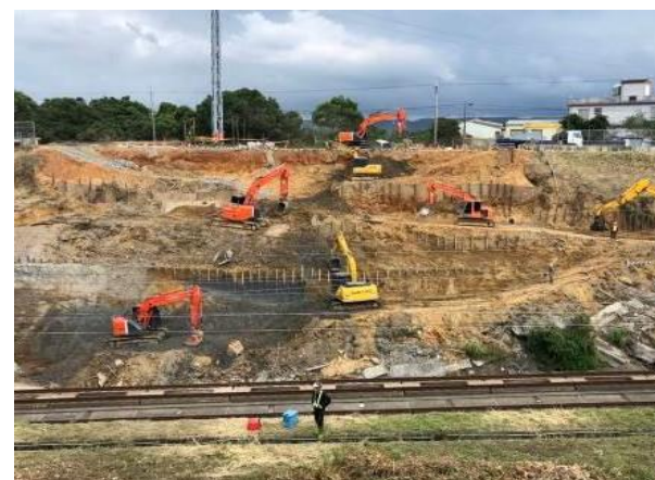
邊坡坍塌搶修工作
