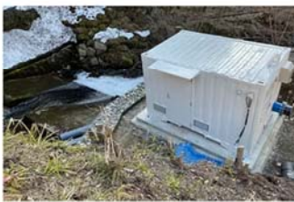
あば村小水力發電所
