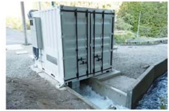
松隈小水力發電所
