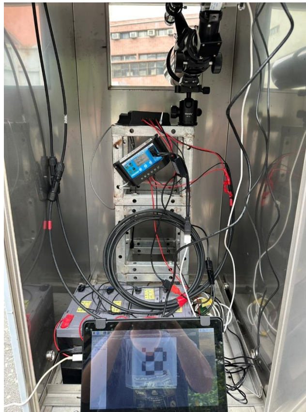
圖 3-36 校內儀器架設示意圖(監測小屋內部配置)
