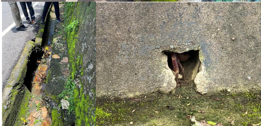
圖 6 小琉球實驗地點及現況照（美人洞擋土牆）。排水孔及水泥結構崩毀處皆可發現紫地蟹之出沒。
