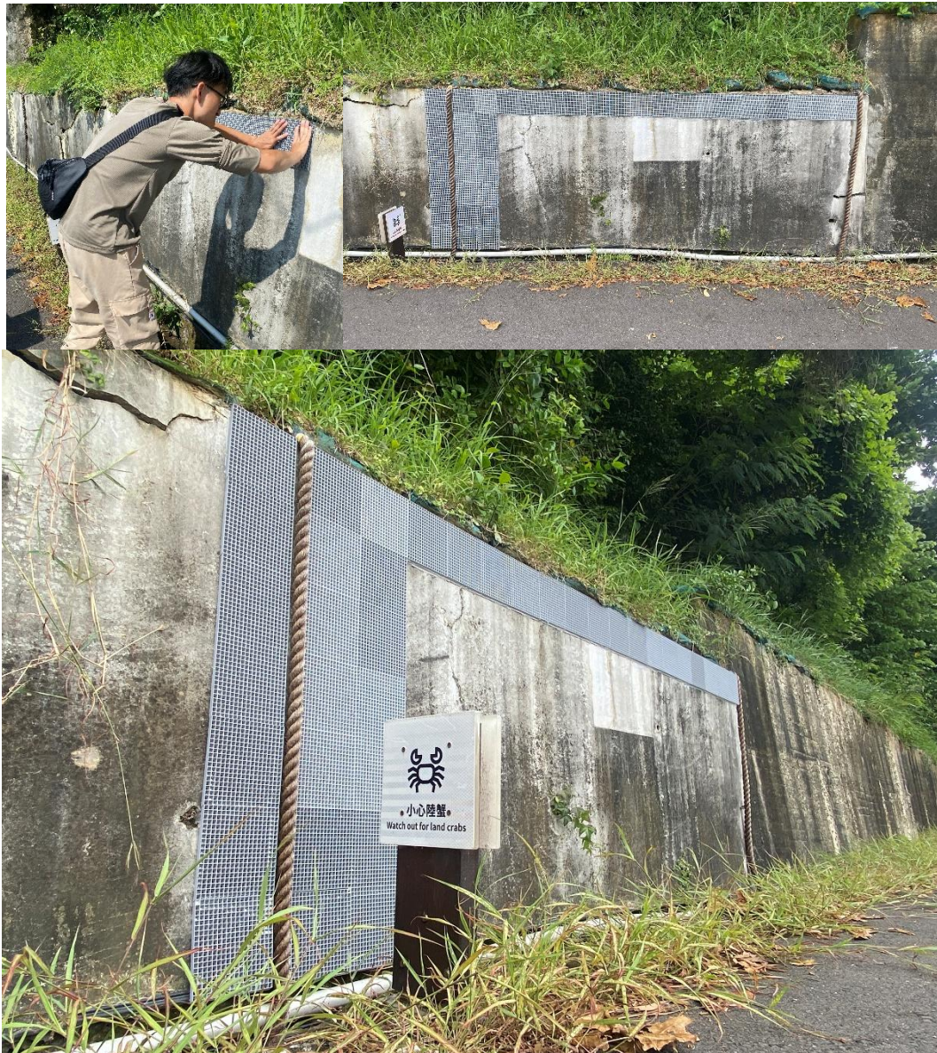
圖 16 小琉球實驗場域架設情況（旭日亭山側擋土牆）
