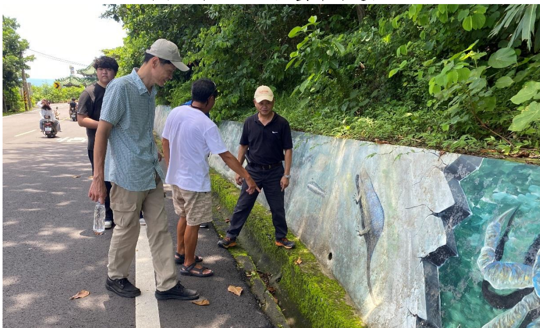
圖 5 小琉球實驗地點及現況照（旭日亭山側擋土牆）。經管理站主任及當地護蟹組織主要負責人指示，擋土牆底部排水溝中段有排水涵管，可供陸蟹降海遷徙。
