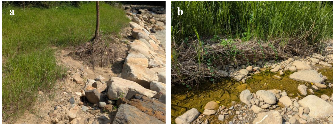
圖 4.2-2、2025 年十月河岸沖刷跡象。a、D1_upp 緩坡區，雖然有堆石阻擋，但上層植生處仍有部分基質被淘刷。b、D2 左岸象草群，可見象草群下方河岸有被淘刷痕跡
