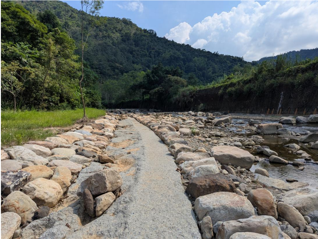
圖 3.2-12、2025 十月 D1_upp 環境照。圖中基座裸露為該年雨季後才發生。緩坡坡頂以上有穩定植生。
