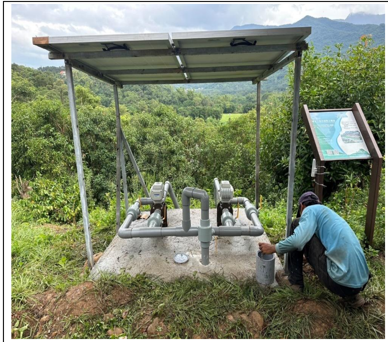
圖 3-19. 電動水閥及太陽能供電系統
