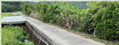
原PC路損壞及鄰溝側無安全措施
