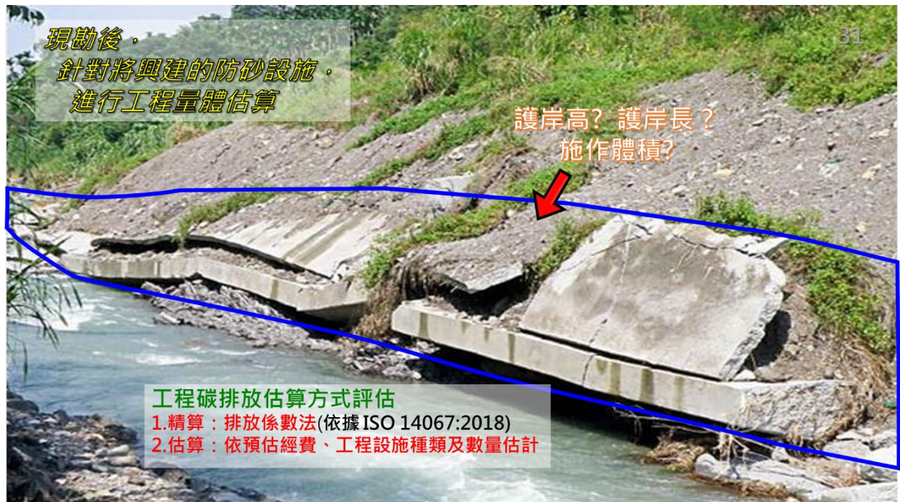
圖 3-18 護岸損壞之範例
