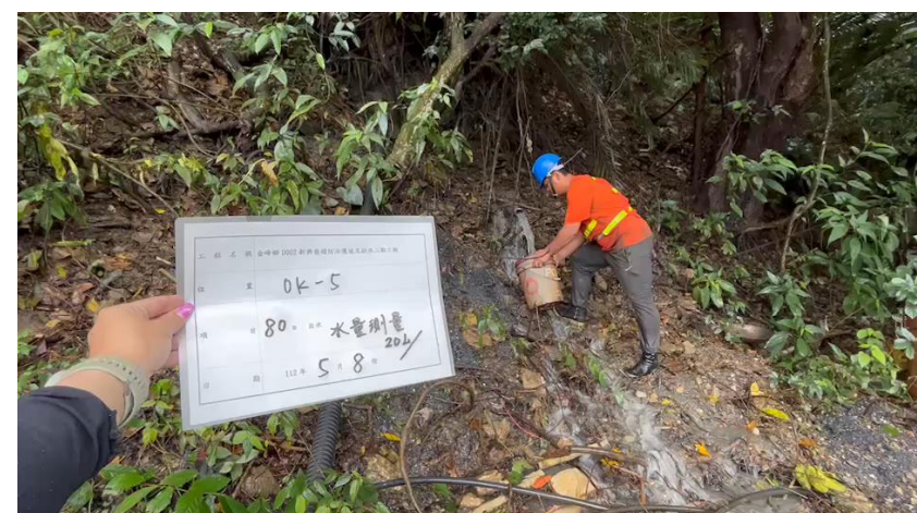
20230505_B工區_0K-005_80m施工後3天出水情形
