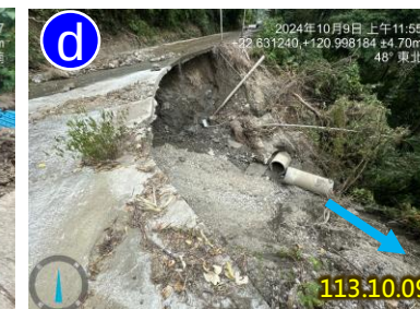
現生崩塌地(2024-02)坑溝逕流冲刷，農東金002路基淘空，影響路段長約20m
