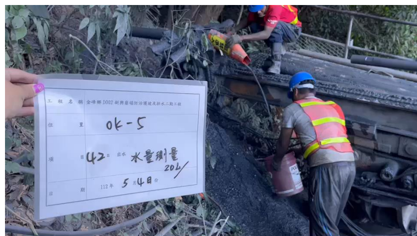
20230504_B工區_0K+007_42m小出水
