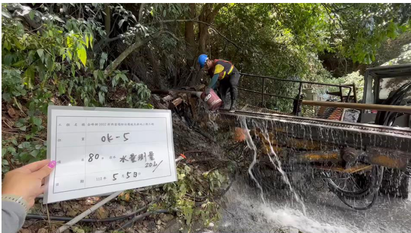
20230505_B工區_0K-005_80m大出水
