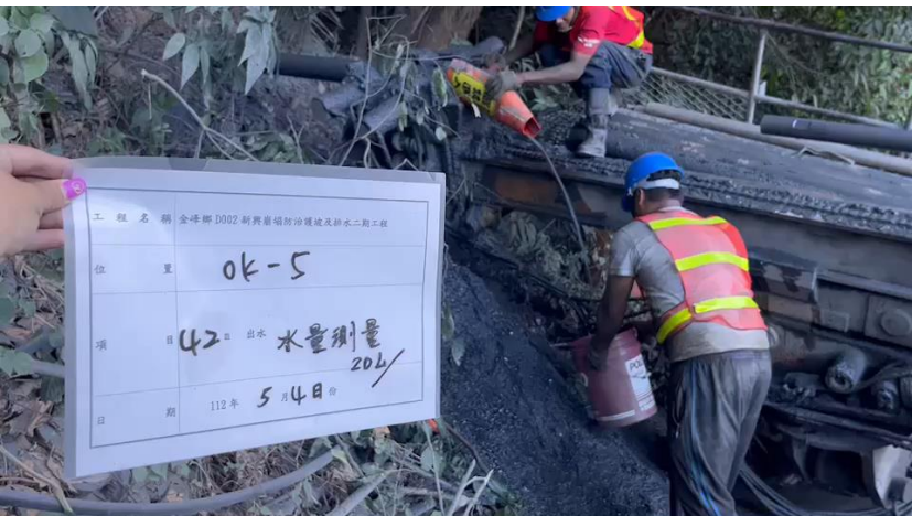
20230504_B工區_0K+007_42m小出水
