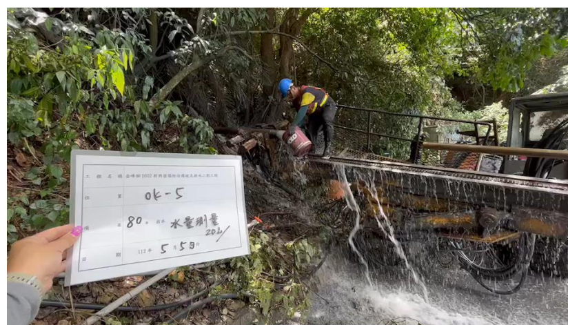
20230505_B工區_0K-005_80m大出水
