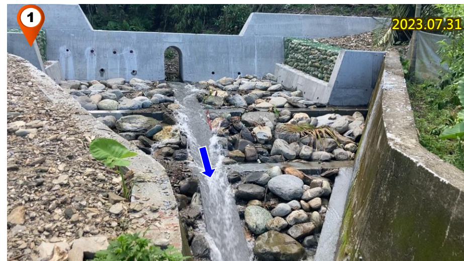
滯洪沉砂壩工2023杜蘇芮颱風後出水情形
