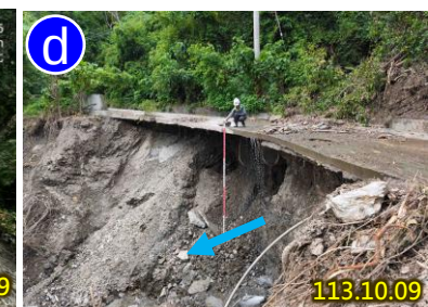
現生崩塌地(2024-02)坑溝逕流冲刷，農東金002路基淘空，影響路段長約20m
