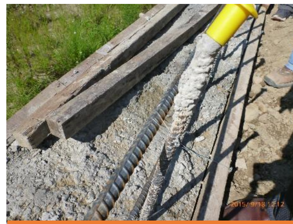
鋼筋綁紮未確實而鬆脫
