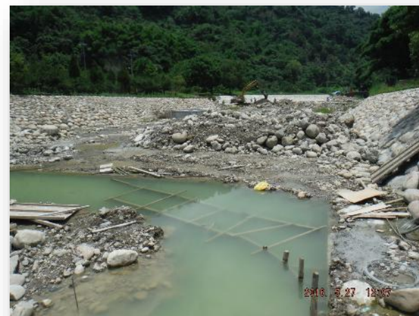
未適當導排水造成組模區位積水
