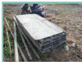
▲ 模板表面釘孔與破邊
