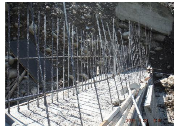
橫向鋼筋綁紮未確實而鬆脫
