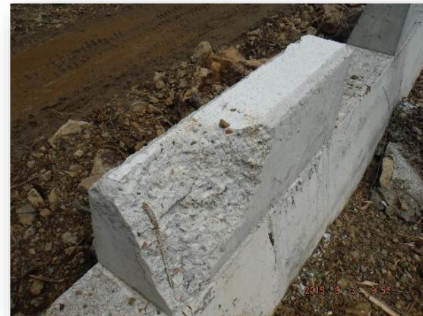
塊狀護欄混凝土尚未硬化而拆模破壞致鋼筋處
