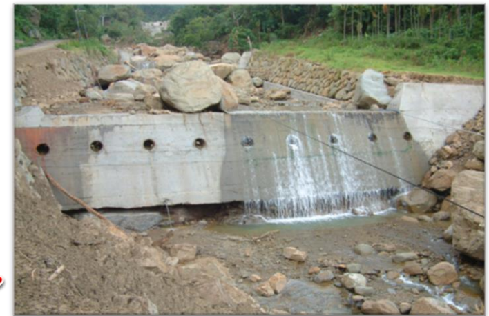
固床工基礎深度不足淘空
