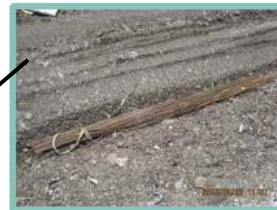
▲ 鋼筋堆置位置不當且未墊高
