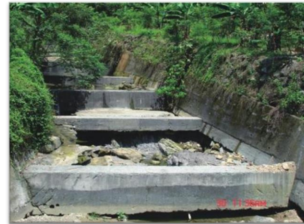
固床工基礎深度不足淘空
