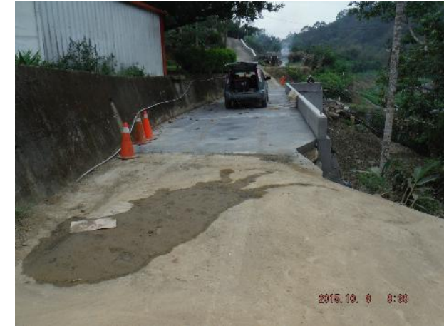
下邊坡銜接不平順恐使用路人危害
