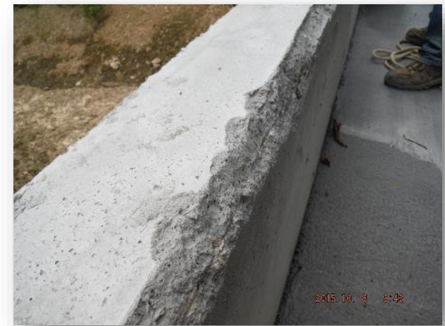
護欄混凝土尚未硬化而拆模破壞致鋼筋處
