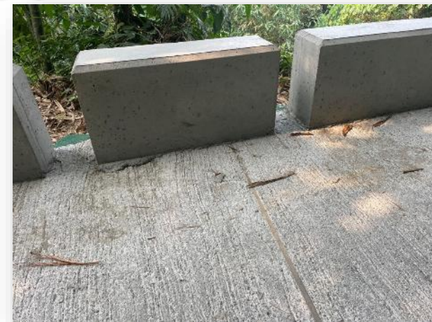
塊狀護欄座落在混凝土路面伸縮縫恐難發揮伸縮縫功能
