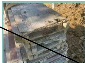
▲ 模板嚴重破損要求退場工地不得使用
