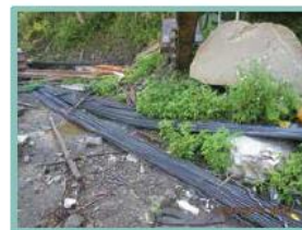
▲ 鋼筋堆置位置不當且未墊高
