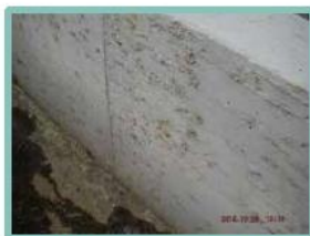
▲ 原模板釘孔多造成混凝土完成面突起
