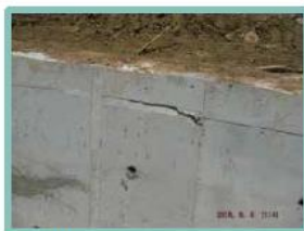
▲ 模板修補不當造成混凝土完成面凹陷
