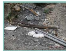
▲ 鋼筋堆置位置不當且未墊高
