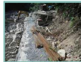
▲ 鋼筋堆置未墊高
