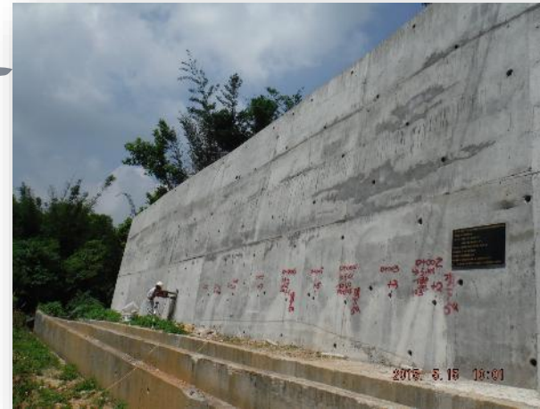
洩水管擺設位置過高過低且排列不齊
