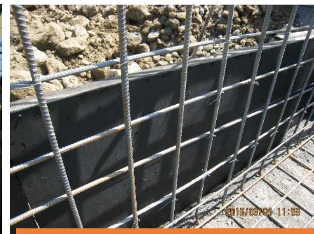
鋼筋綁紮未確實
