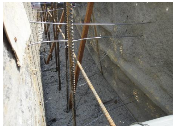
鋼筋未綁紮恐澆置位移
