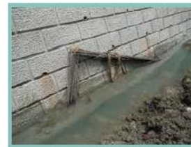
▲ 鋼筋堆置位置不當造成鋼筋腐蝕
