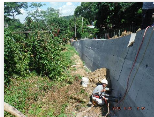
擋土牆澆置後未鏟平 頂面線形成波浪狀
