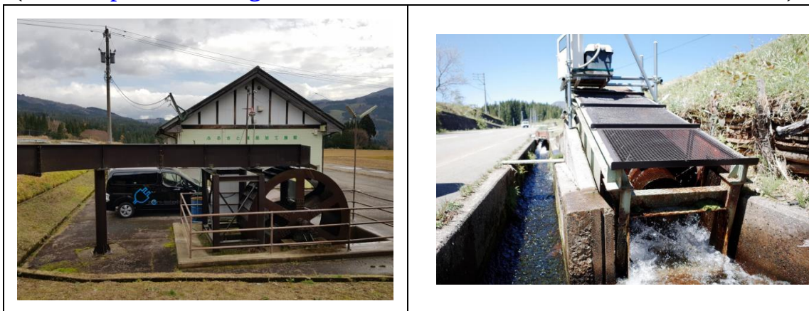
圖 2-2-5 岐阜縣郡上市石徹白地區小水力發電機組圖
