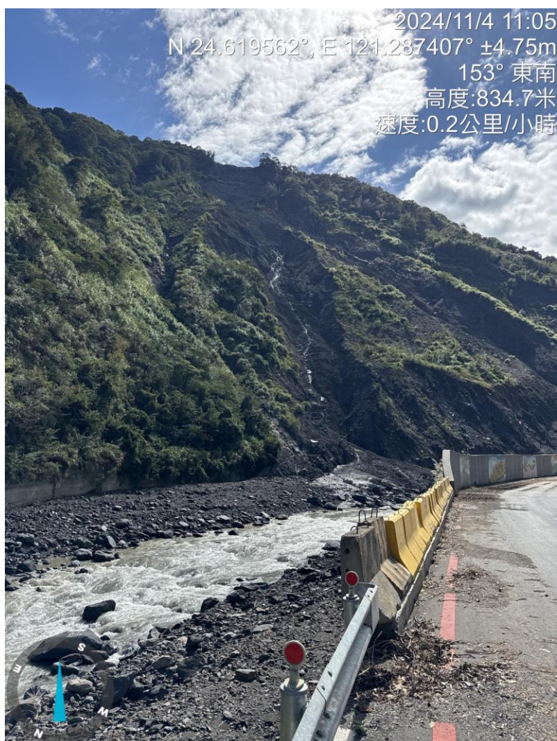
圖 3-52 康芮颱風後 DS194 活動邊坡現況
