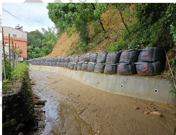
圖 3-33b 高雄市大樹區野溪整治右岸年久失修及溪底沖刷待維護現址照片 B
