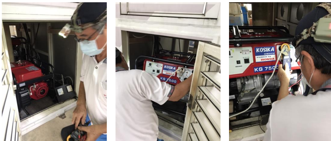
圖 3- 44 GB-SAR 車廂發電機(1)-電流檢測
