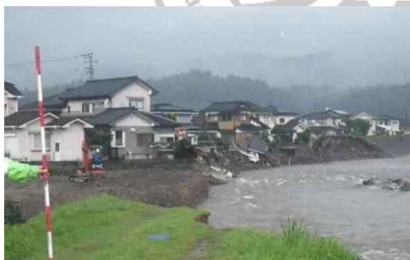
河岸侵蝕引致家屋倒塌（花月川）
