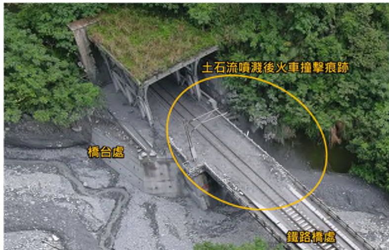
圖 4-32 災後鐵路橋處空拍
