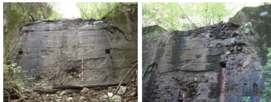
圖 5-6 凍害引致混凝土剝離現象（長野縣內之節制壩案例）
