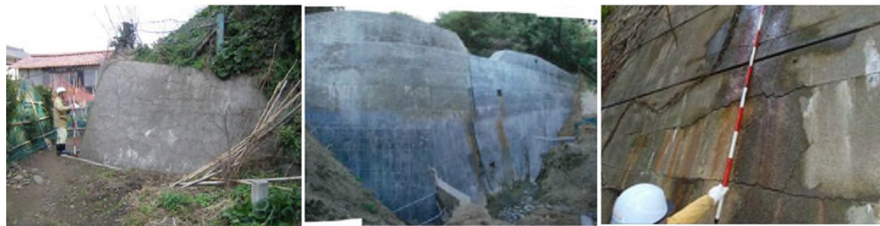
圖 5-12 鹼粒料反應引致治山設施劣化之案例
