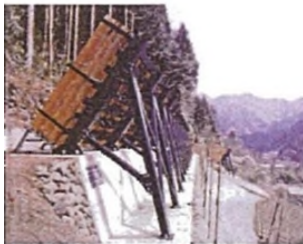
落石防止壁(鋼製)
