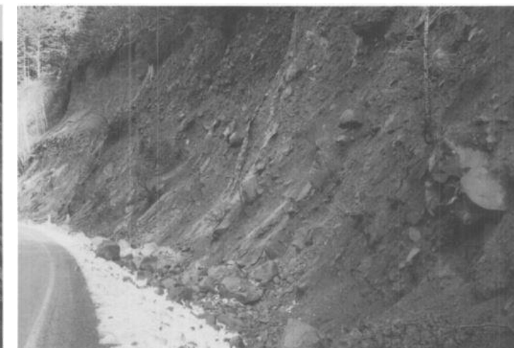
圖 5.25：過度陡峭的土壤/岩石邊坡
