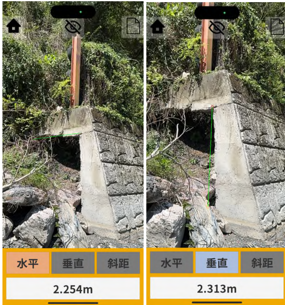
大規模崩塌潛勢區(投縣-仁愛-D067)右下方坡腳崩塌 崩塌本體右側尚存既有擋土牆側邊掏空尺寸
