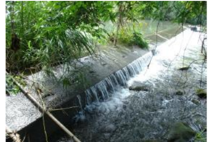
構造物右側斷裂情形
