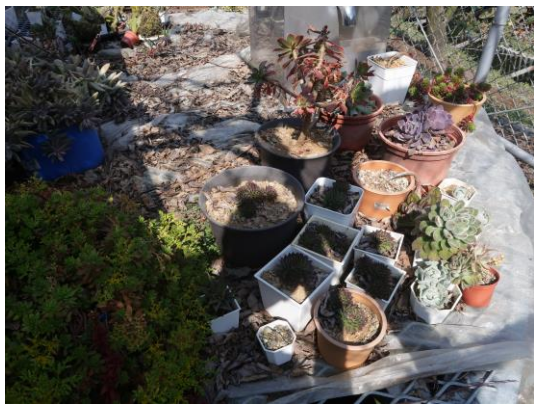
井蓋外觀(居民放置植物)
