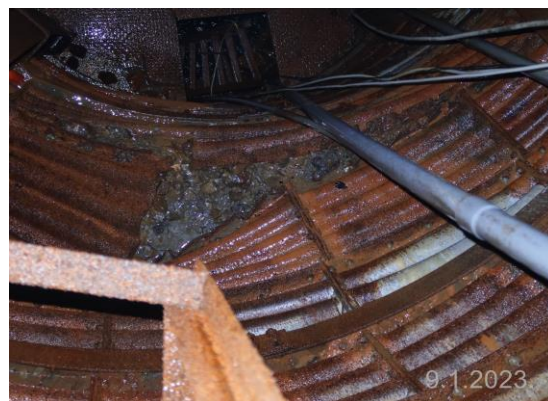
壁面情形(生鏽、破裂變形)
