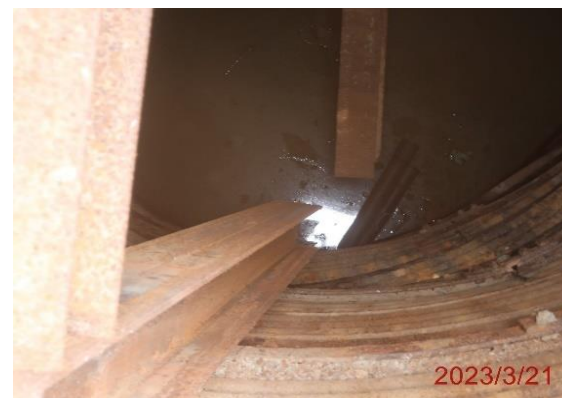
十字加固還斷裂、井桶變形
