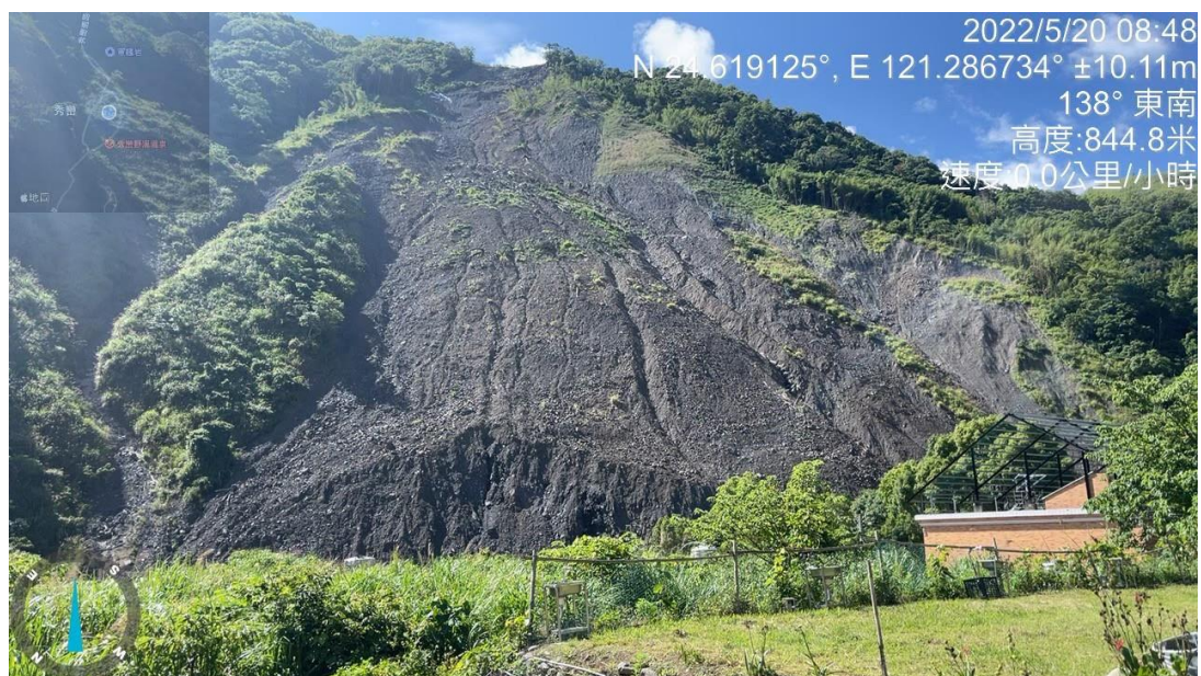
圖 3-9 DS194 崩塌地現地照片(2022/5/20)
