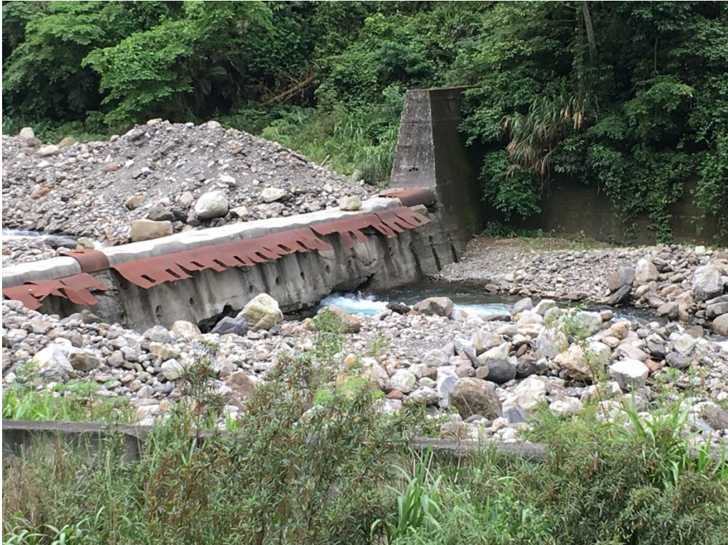
台中東勢雪山坑溪壩頂鋼版破損實況
