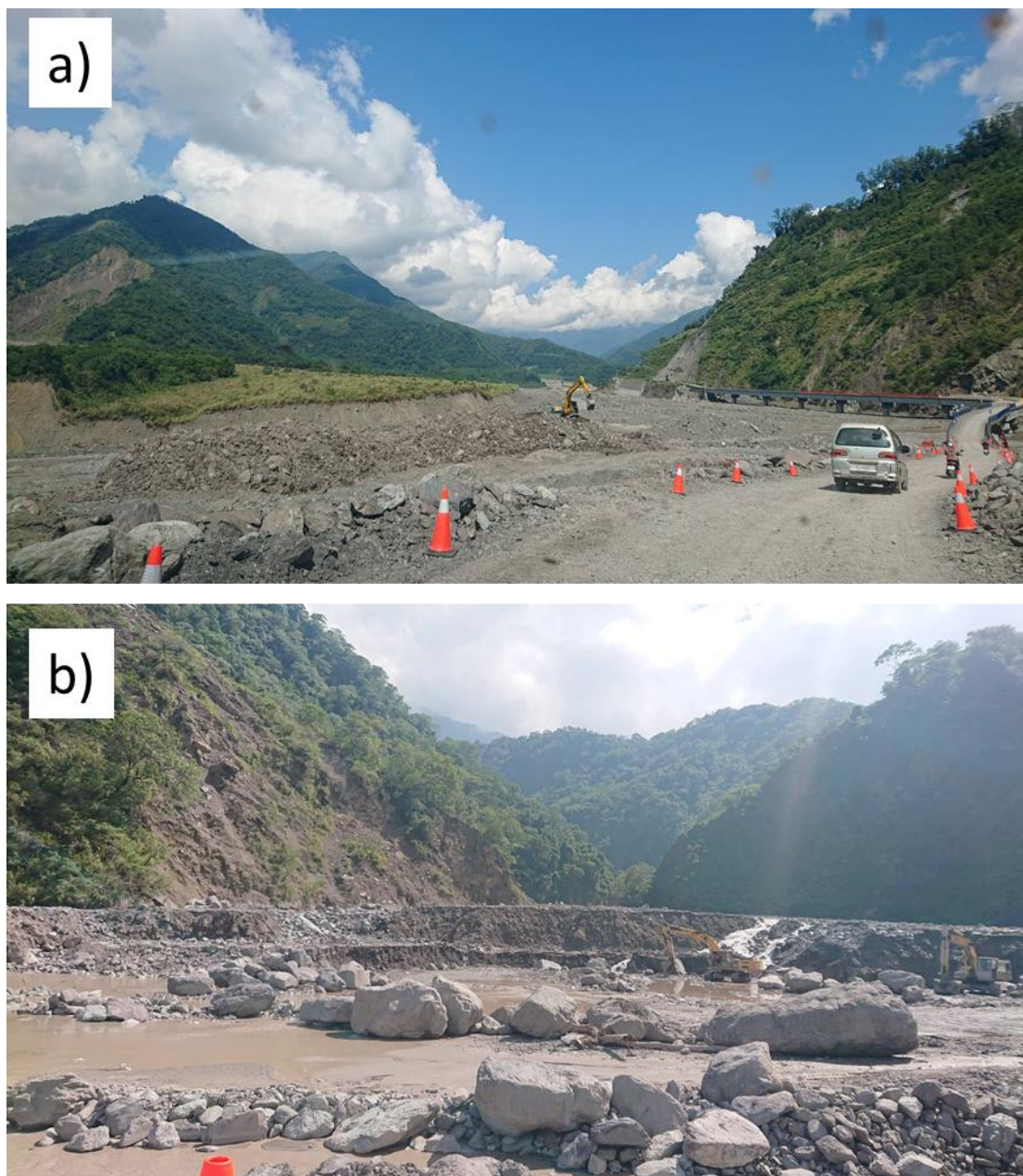
圖 2-11 玉穗溪 8 月 7 日降雨事件後現況。(a)明霸克露橋毀壞後施工狀況，(b)玉穗溪河床大量土石堆積情形(照片為本計畫於 2021 年 10 月 24 日拍攝)
