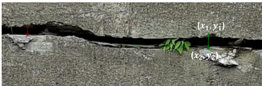
圖 2-7:人工標註裂隙影像。(紅線)60mm 寬裂隙;(綠線)100mm 寬裂縫
