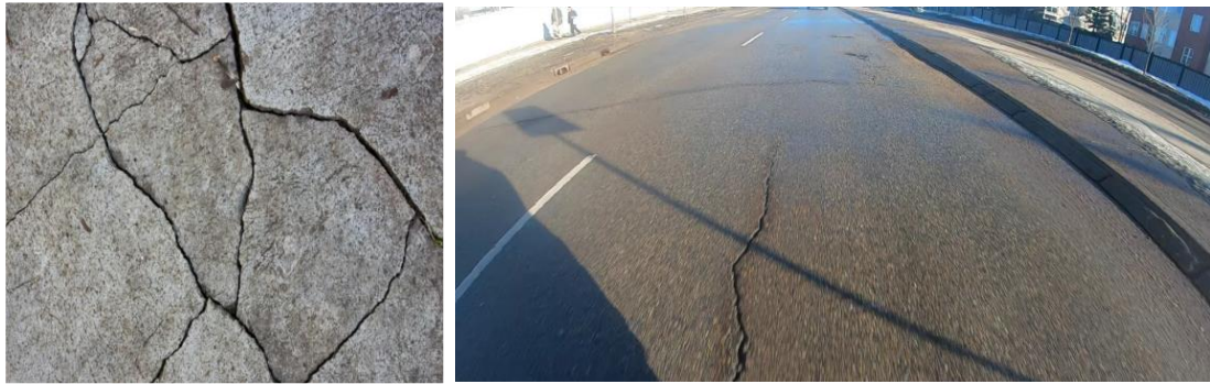
圖 2-32: (a)kaggle 裂縫影像，(b)路面裂縫影像
