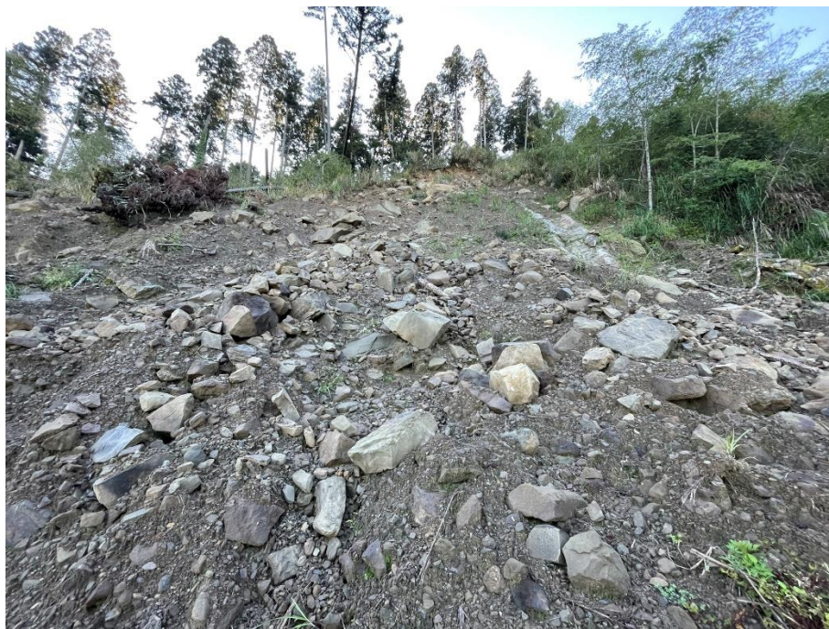
圖(2-10) 阿里山青年活動中心聯外道路崩塌案
