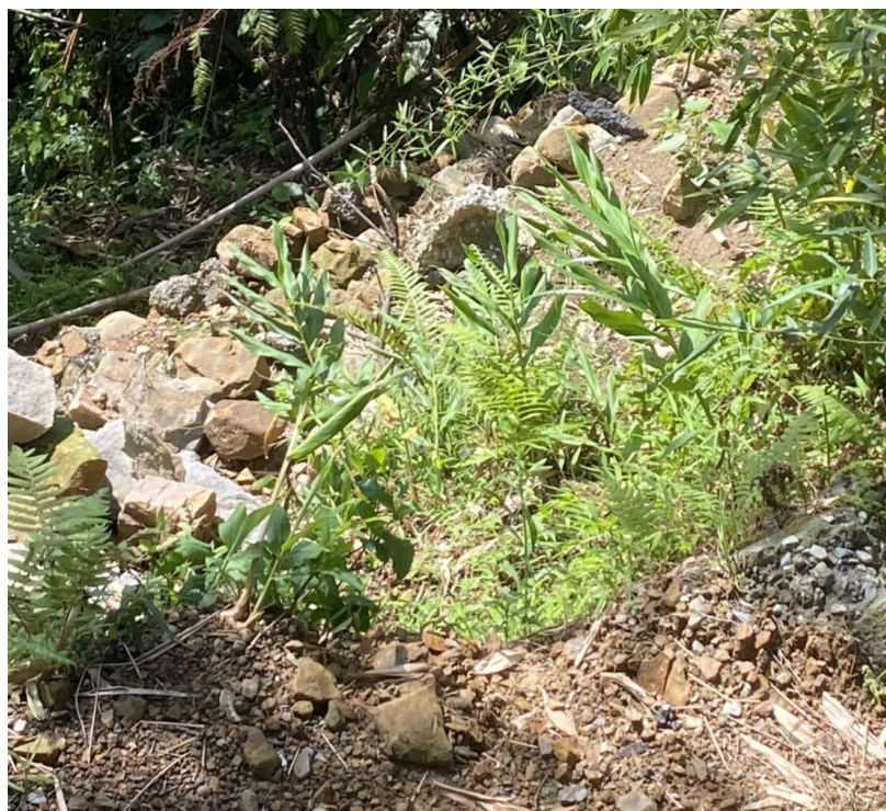
圖(2-13) 大崙山聯外道路崩塌案
