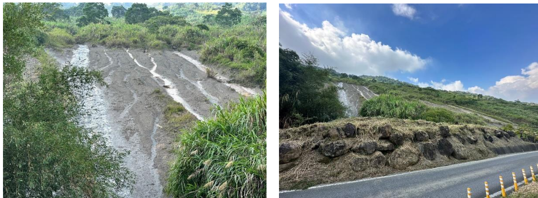
圖 4-9 大崩塌區域岩土與植生現況
