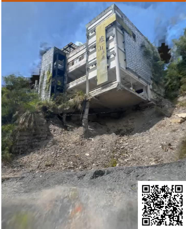
遠距離(傾斜建物&崩塌)
