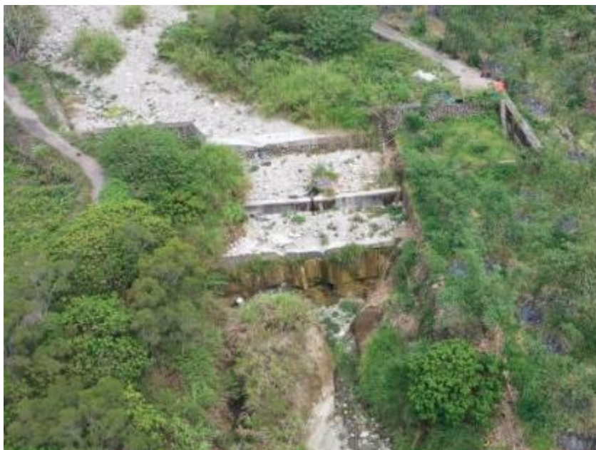
廊仔溪調整型防砂壩施作前上游土砂堆積、下游嚴重侵蝕
