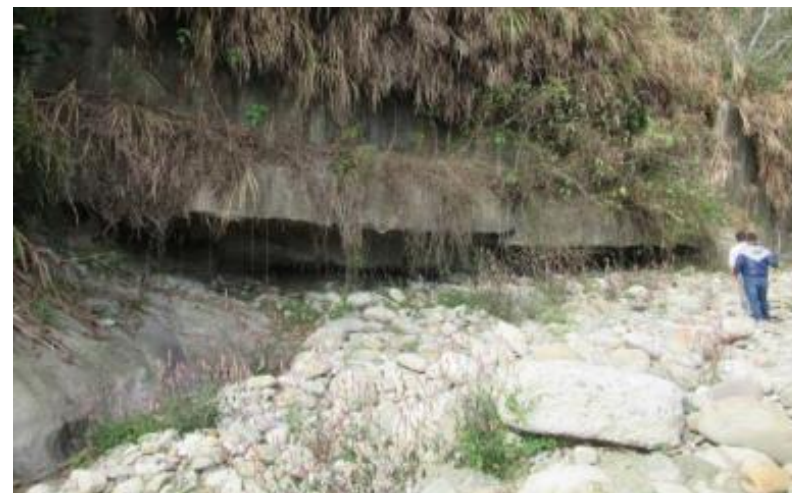
廊仔溪下游凹岸淘刷基礎裸露
