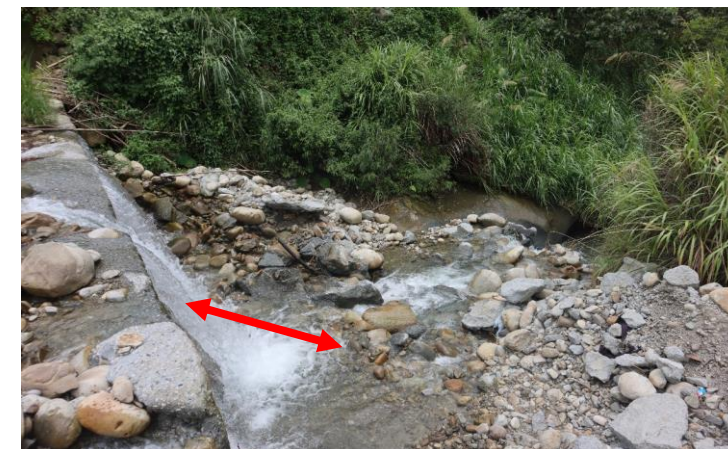
下游主要保全對象:5K+065固床工 下游沖刷坑(平均沖刷深度2.85m)
