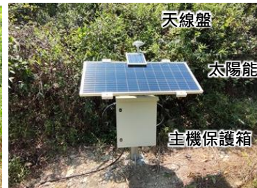
D010-GM2-主機及供電系統
