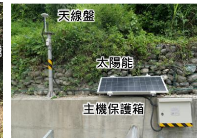
D010-GM2-主機及供電系統
