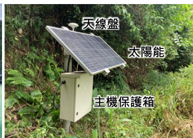
D010-GM1-主機及供電系統
