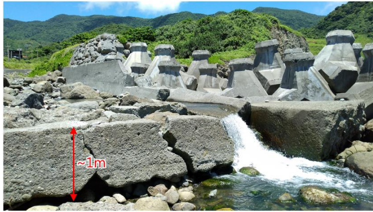
圖3-4 大不岸溪河口固床工現況存在高差之影像
