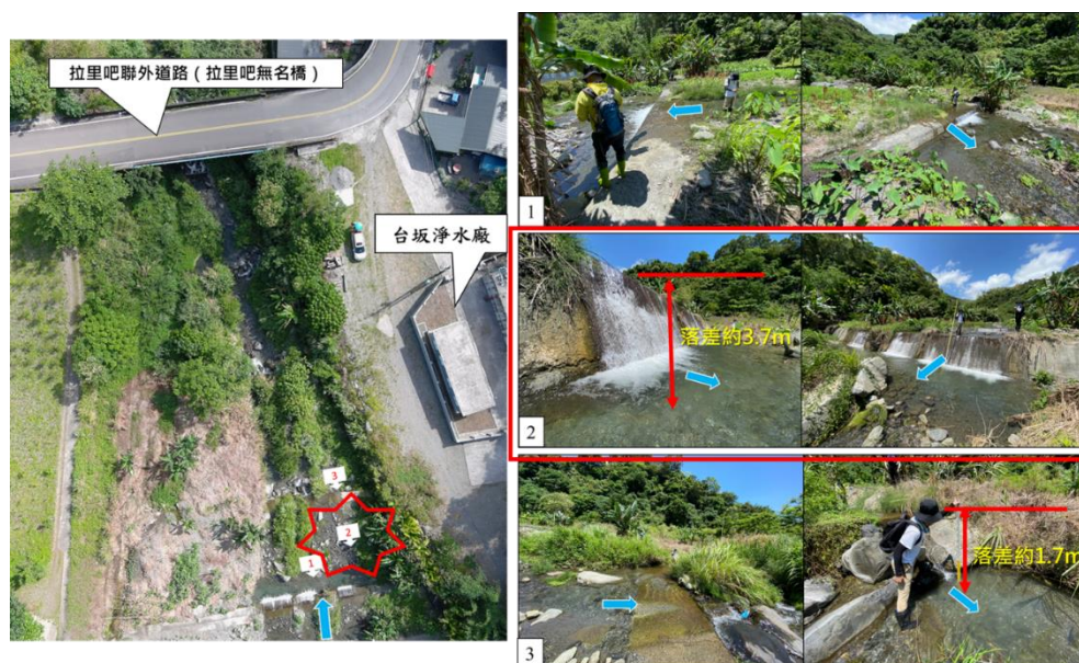
圖3-78 拉里吧溪無名橋上游固床工下游落差大情形
