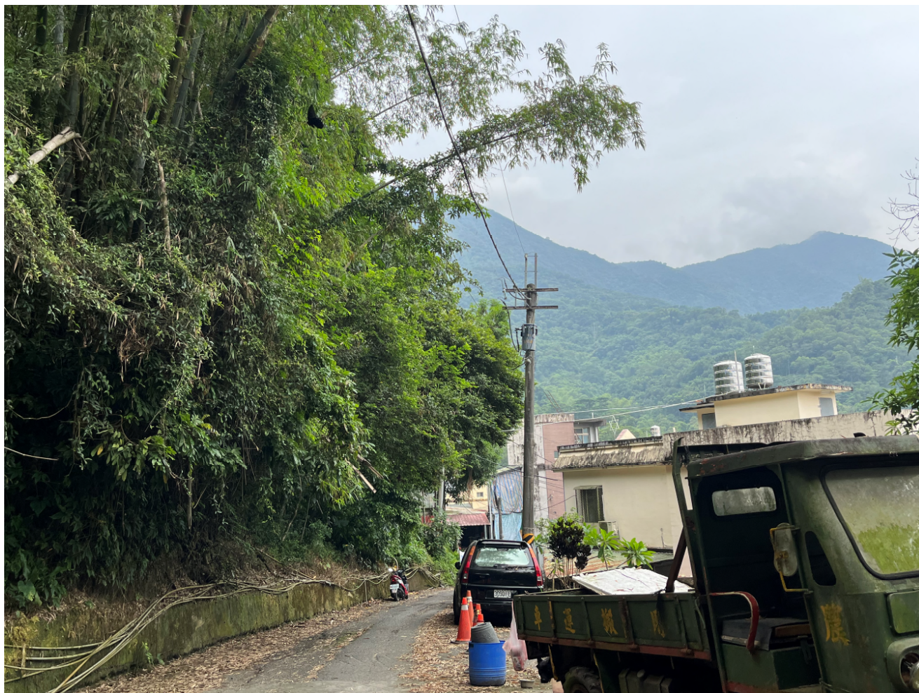
圖 4-29 青葉部落邊坡及道路狀況
