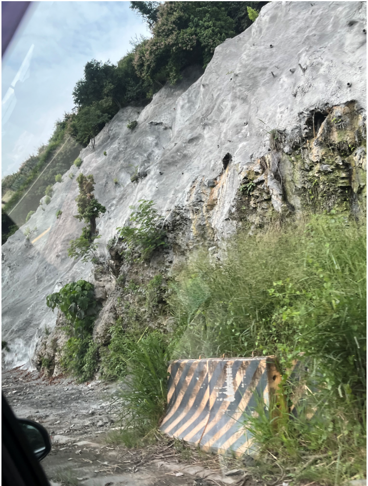
圖 4-28 尾寮山臨近山坡之大規模崩塌及護坡
