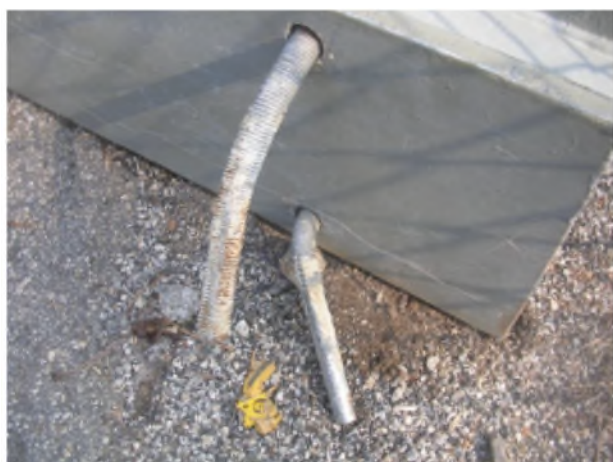
圖 2-11 亞特蘭大化學錨栓失效倒塌案
