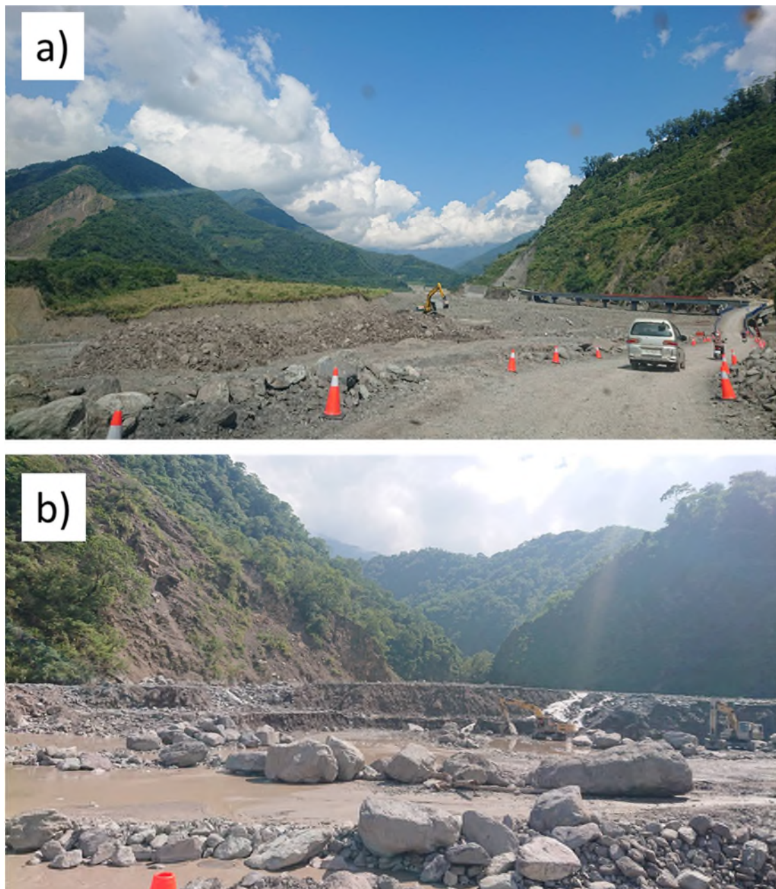
圖 2-2 研究區復興河段 8 月 7 日降雨事件後現況。a)明霸克露橋毀壞後施工狀況，b)玉穗溪河床大量土石堆積情形(照片於 2021 年 10 月 24 日拍攝)
