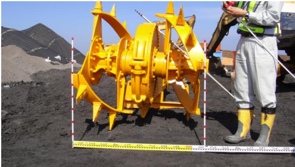
圖附-5 WILL攪拌頭(台中電廠灰塘區地改試驗)
