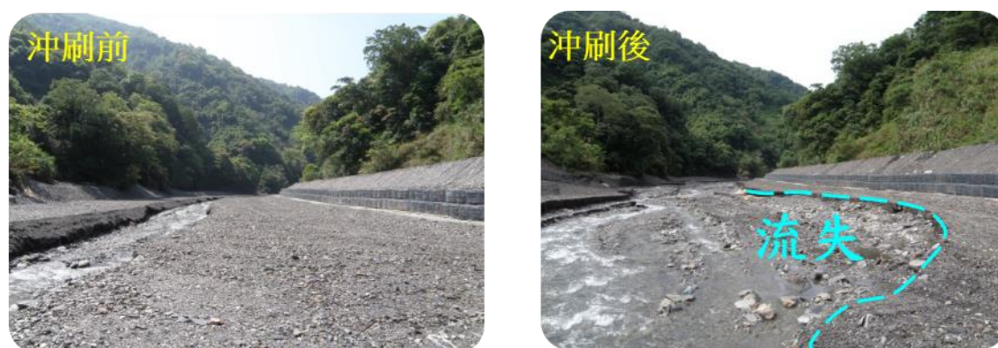
圖5-46 溪水沖刷導致土石流失
