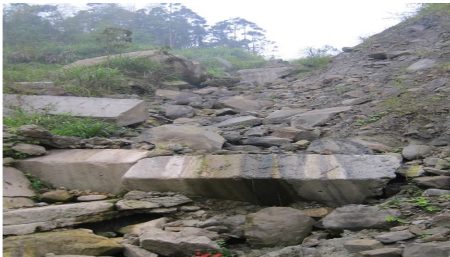
圖 2-3 設施已呈沖毀崩壞樣態
