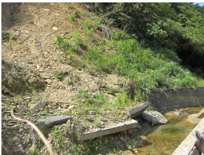
圖 2-4 崩塌地滑樣態
