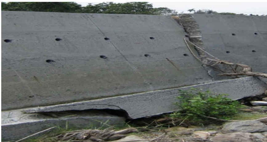
圖 2-2 設施呈沖毀破壞樣態
